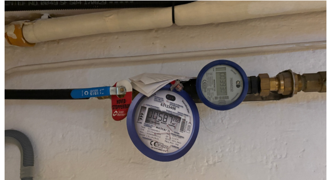
Stoppekran i kjeller
