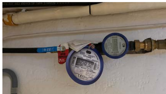
Stoppekran i kjeller
