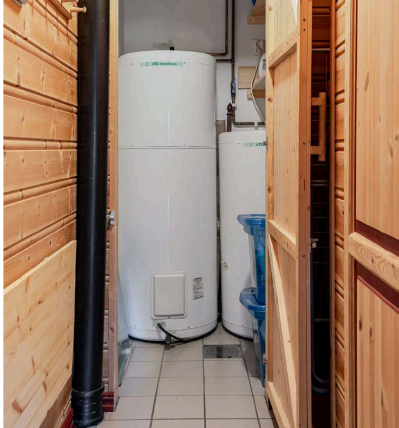
Teknisk rom/bod med både lagringsplass og varmtvannsbereder.
