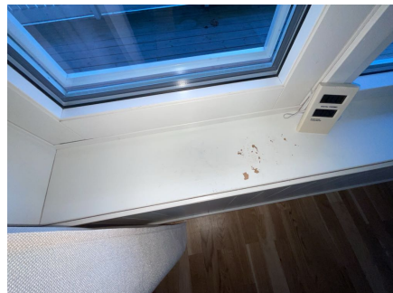
Skade i vinduskarm på stue
