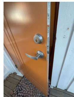
Skade på dørkant og nedre del av hoveddør
