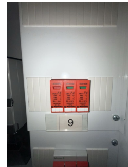
En patron på overspenningsvernet er merket rød og må da byttes
