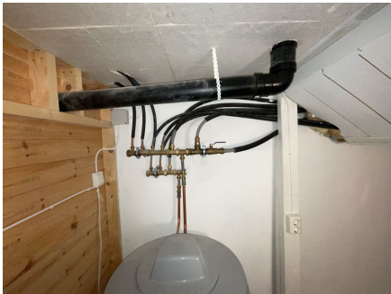
Vannledninger og stoppekrane er montert åpent på vegg i kjellerbod
