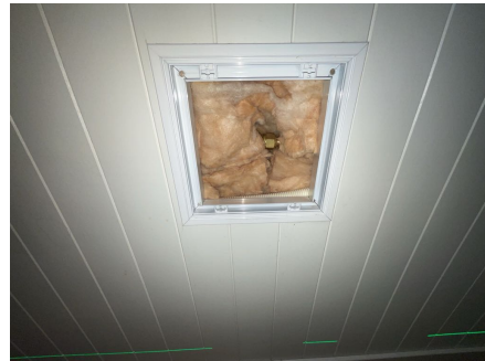
Inspeksjonsluke til utekran på soverom 2 mangler vannføler som er tilkoblet vannstopventil
