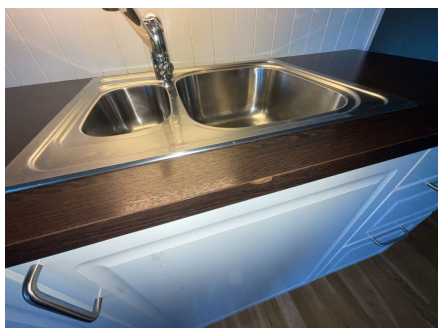
- Skade på laminat benkeplate ved vask
