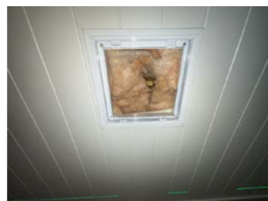
Inspeksjonsluke til utekrane på soverom 2 mangler vannføler som er tilkoblet vannstoppventil
