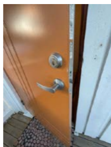
Skade på dørkant og nedre del av hoveddør
