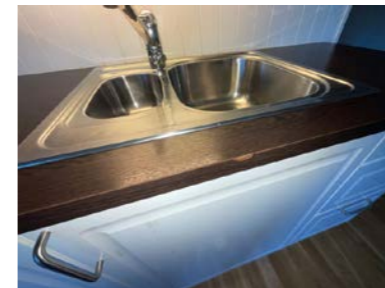
- Skade på laminat benkeplate ved vask
