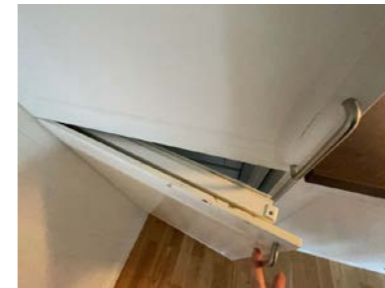
- Overflateskade på dørfront fryseskap og kjøleskap
