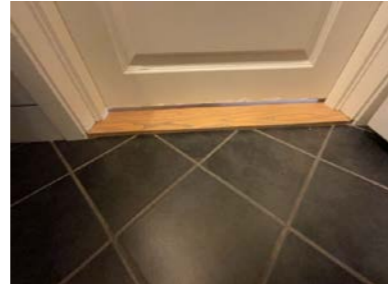
Tilluftsspalte under dør
