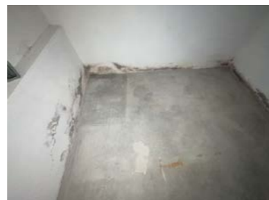
Synlig saltutslag på gulv og vegger i bod
