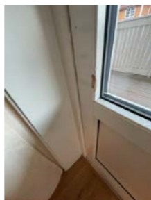
Skade innvendig på verandadør
