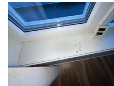
Skade i vinduskarm på stue
