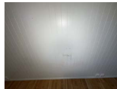
Overflateslitasje på soverom 2
