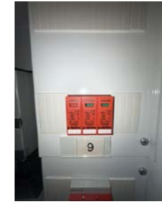
En patron på overspenningsvernet er merket rødt og må da byttes
