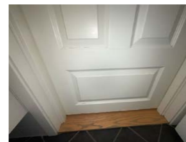
Skade på dør som er synlig inne på badet
