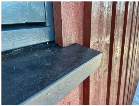
Fare for fuktopptrekk i omramning.
