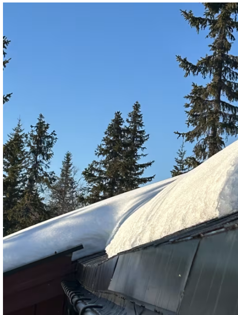
Nedbøyning på tak og takrenne.
