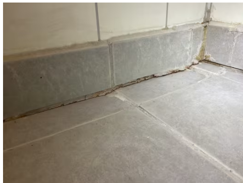
Sprekk i flis og fuger.
