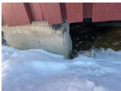
Fundament med sprekk.
