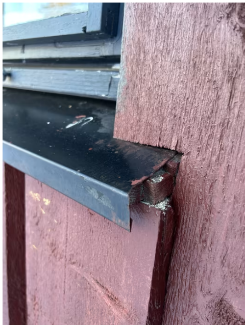
Ufulstendig beslag under vindu.
