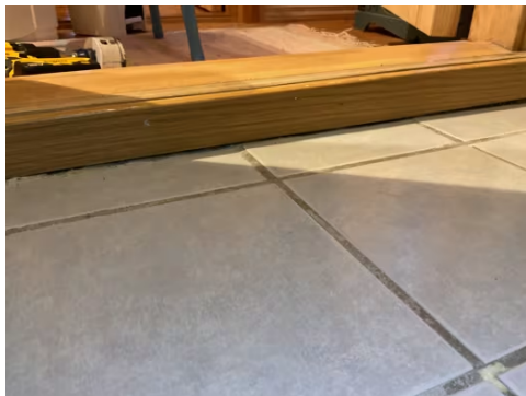
Manglende tettesjikt ved dør.
