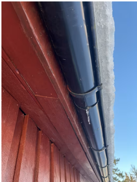
Manglende tetting i skjøl.
