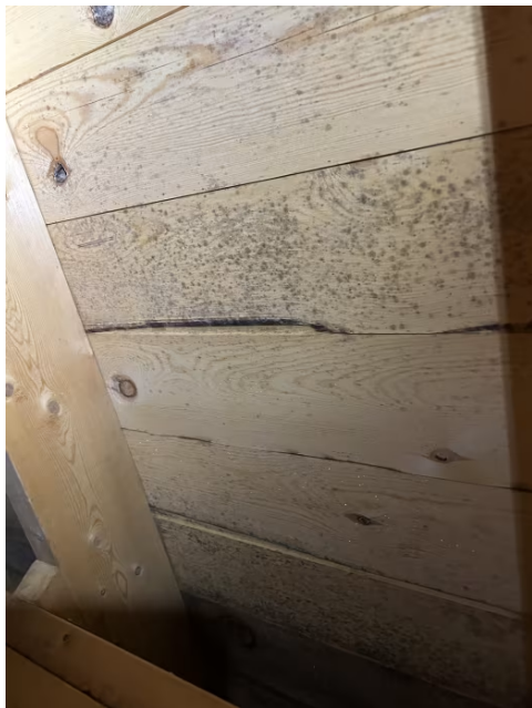
Missfarging i undertak.
