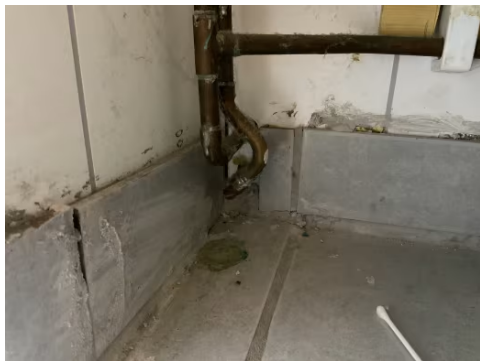
Vannmerker på gulv på bad.
