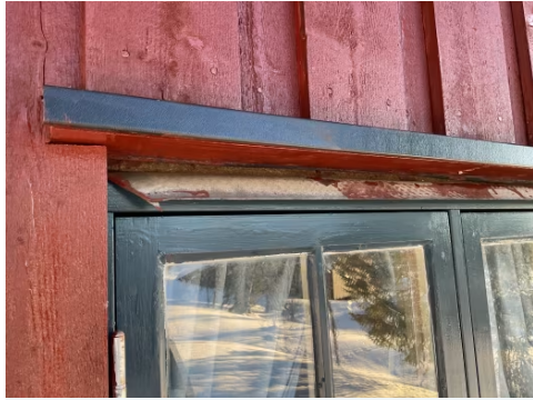
Ufullstendig belistning over vindu.
