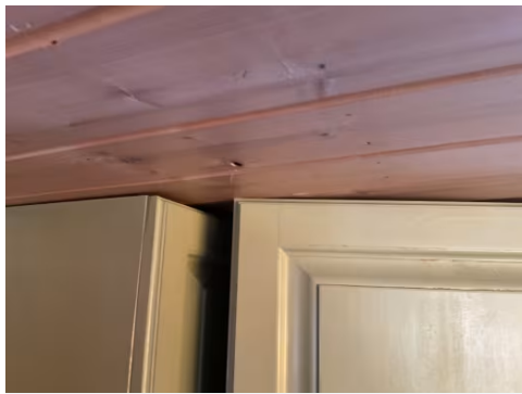
Skapdør tar i taket.
