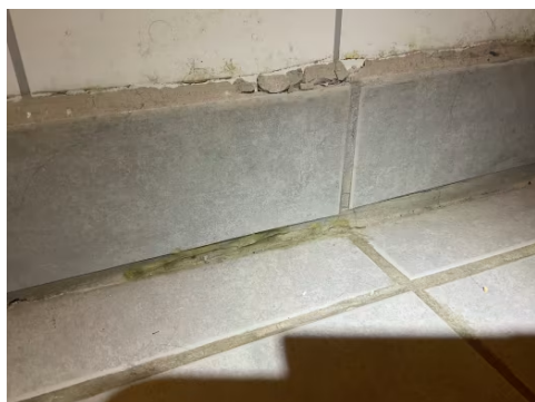
Sprekker i fuger og silikon.
