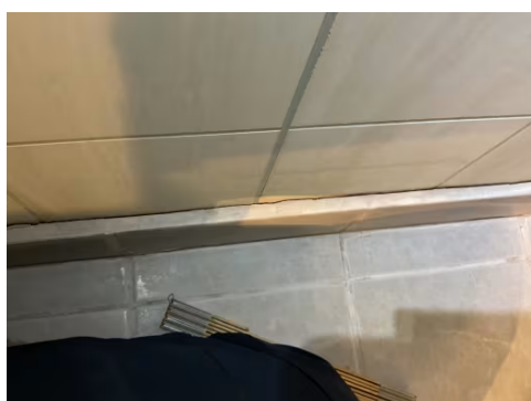
Sprekk mellom plater og sokkelflis.
