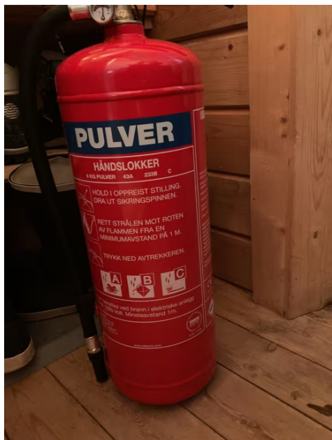
Brannslukker plassert i gang.
