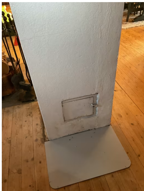
Sprekk i pipe.
