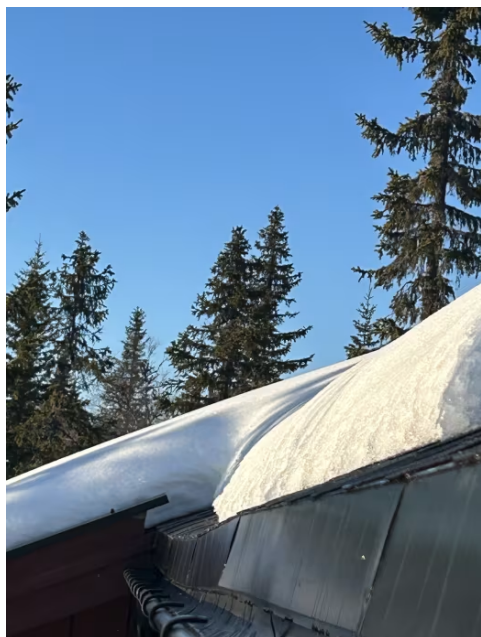
Svai/nedbøy i takflaten.
