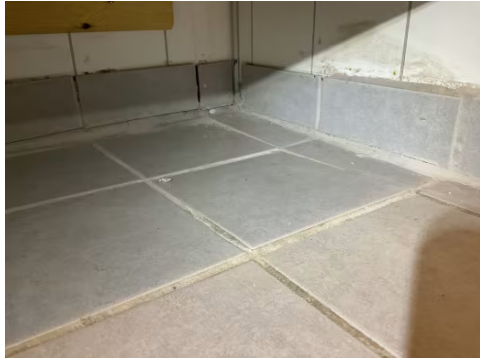
Ufagmessig utførelse. Manglende fugemasse og silikon.
