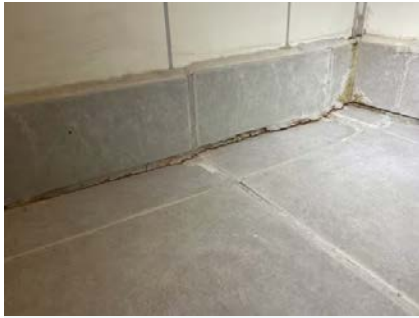
Sprekk i flis og fuger.
