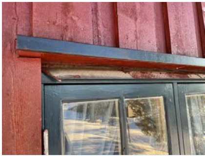
Ufullstendig belisting over vindu.
