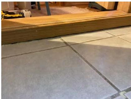
Manglende tettesjikt ved dør.
