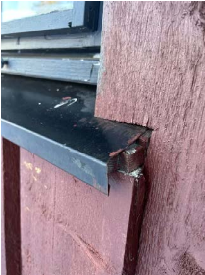
Ufulstendig beslag under vindu.
