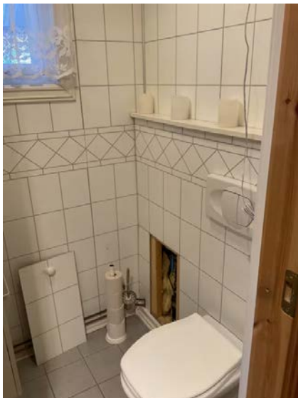
Kasse for sisterner og stoppekran.
