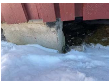
Fundament med sprekk.
