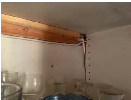
Viser løst kjøkkenskap.
