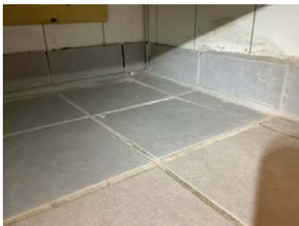
Ufagmessig utførelse. Manglende fugemasse og silikon.
