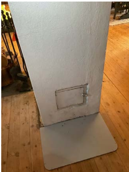
Sprekk i pipe.
