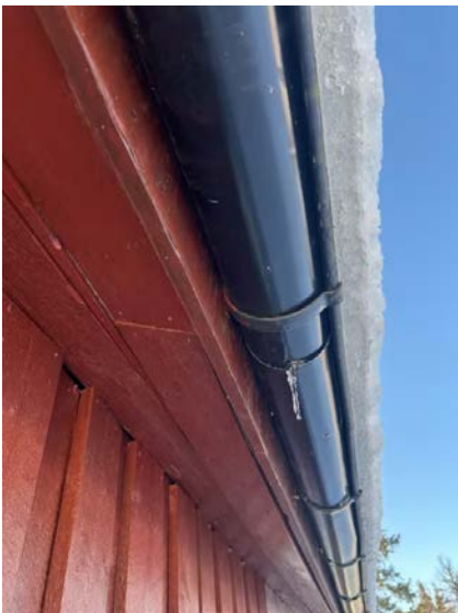
Manglende tetting i skjøt.
