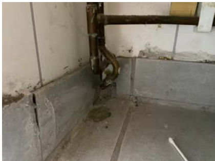
Vannmerker på gulv på bad.
