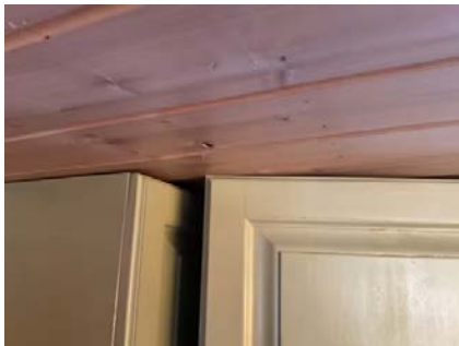
Skapdør tar i taket.
