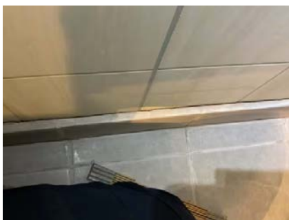
Sprekk mellom plater og sokkelflis.
