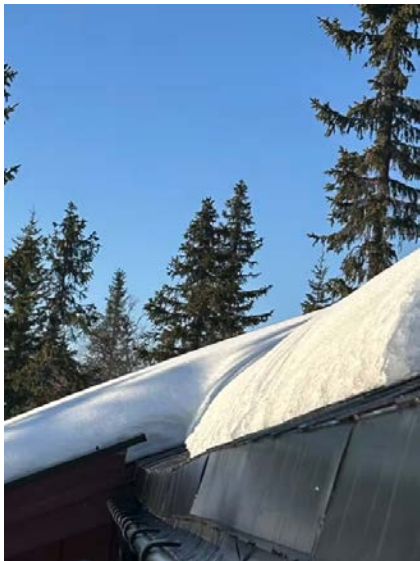
Nedbøyning på tak og takrenne.
