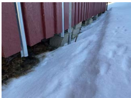
Fundamenter med utglidning.
