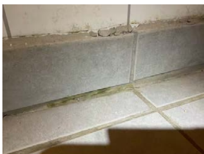
Sprekker i fuger og silikon.
