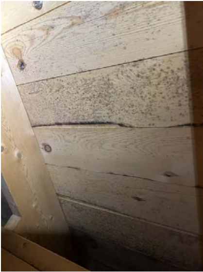
Missfarging i undertak.
