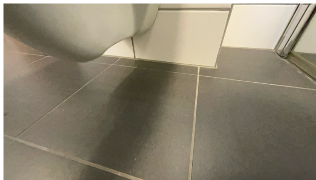
Lekkasjespalte på innebygget sistene bør opparbeides.
