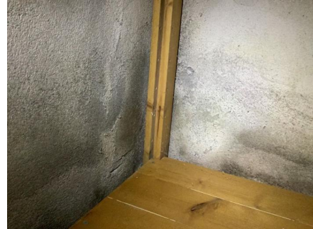
Saltutslag på åpen grunnmur.
