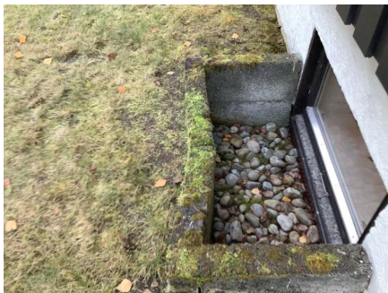
Skjeve blokker i lysgrav.
