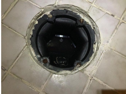
Plastsluk, uten synlig tettesjikt rundt sluk.
