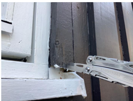
Spredt råteskade i bordkledning.
