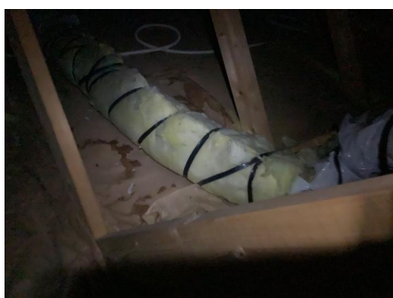
Fuktskjolder på papir på isolasjon.
