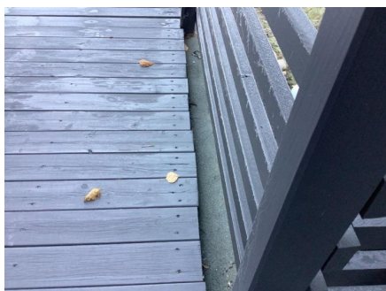
Eksempel på grov utførelse.
