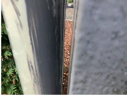
Eksempel på frostsprengt nedløpsrør.
