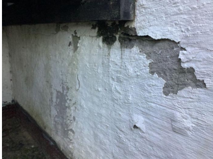
Løs puss på tilbygget garasje.
