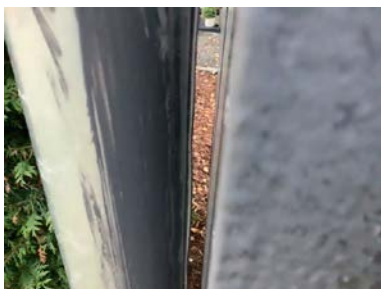
Eksempel på frostsprengt nedløpsrør.
