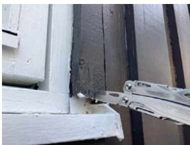
Spredt råteskade i bordkledning.
