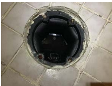
Plastsluk, uten synlig tettesjikt rundt sluk.
