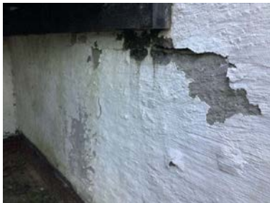
Løs puss på tilbygget garasje.
