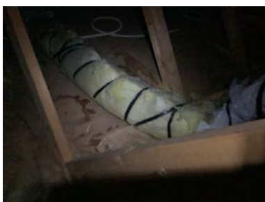
Fuktskjolder på papir på isolasjon.
