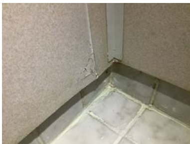
Tegn til fuktskader i nedkant av baderomsplater.
