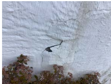
Løs puss på tilbygget garasje.
