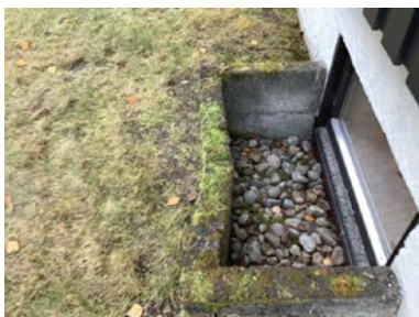
Skjeve blokker i lysgrav.
