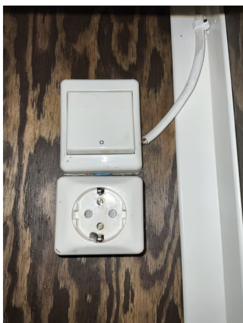
Isolasjon avsluttet utenfor kapsling til bryter på bad. Kabelen fremstår ufagmessig lagt opp.
