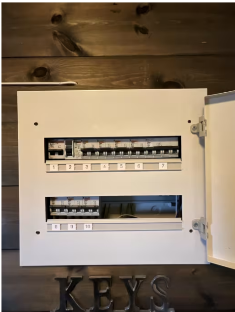
Viser innfelt sikringsskap plassert i vindfang. Det mangler avdekking i sikringsskap. Skap må justeres slik at sikringer tetter hull i ramme.
