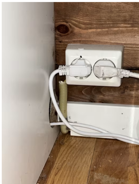
Rør avsluttet utenfor kapsling.
