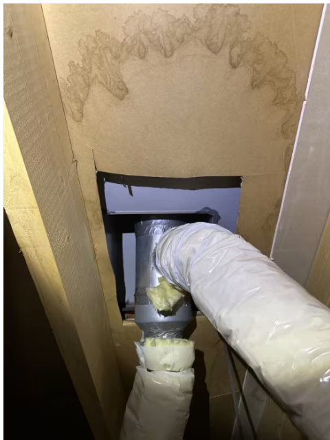
Det er påvist fuktskjolder i undertak/takkonstruksjon.
