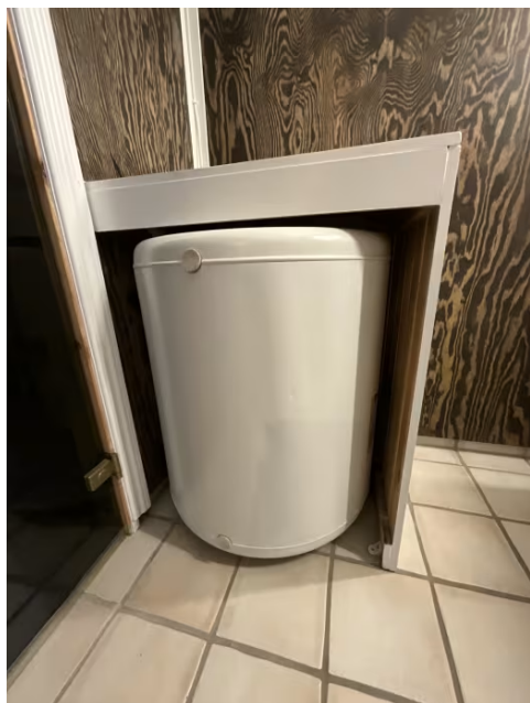
Viser bereder plassert på bad.
