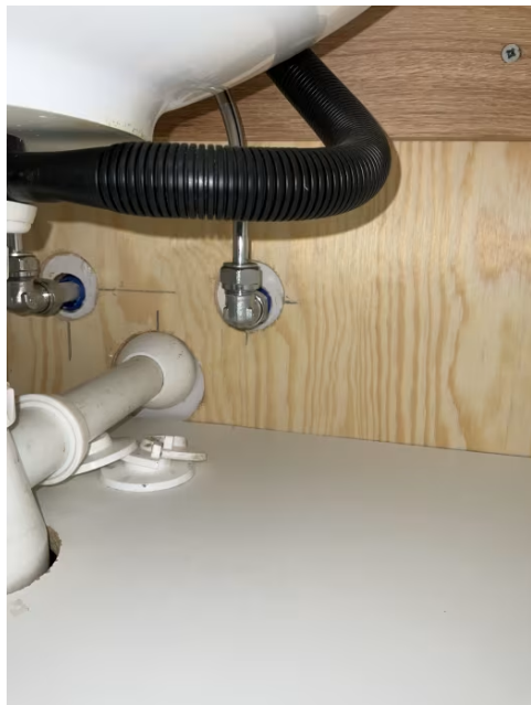
Det er ikke synlig tettesjikt rundt rørføringer i vegg.
