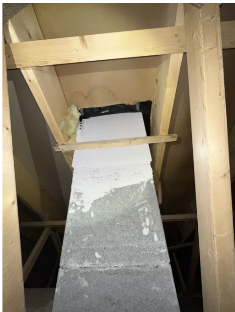
Det er påvist fuktskjolder i undertak/takkonstruksjon ved pipe.
