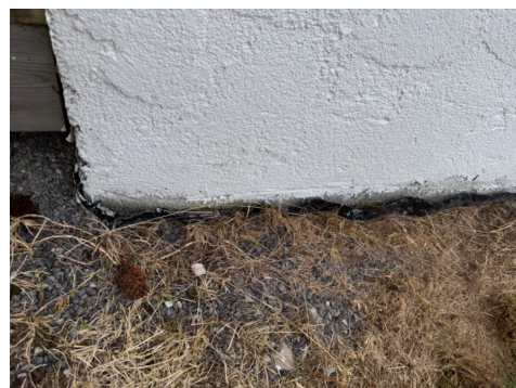
Manglende klemplister i topp på fuktsperre.
