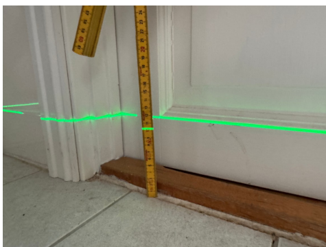
Målt høyde ved dørterskel 10,2 cm
