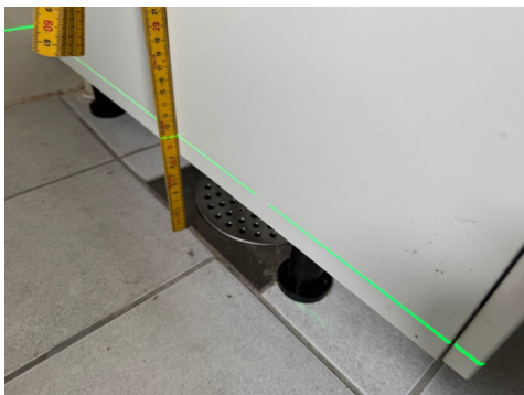
Målt høyde ved sluk 11 cm
