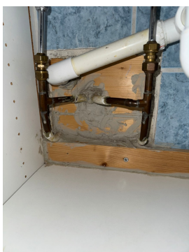
Røropplegg i kobber med plastkappe.
