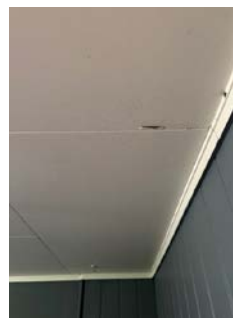
Noe skader og vridning i folierte takplater
