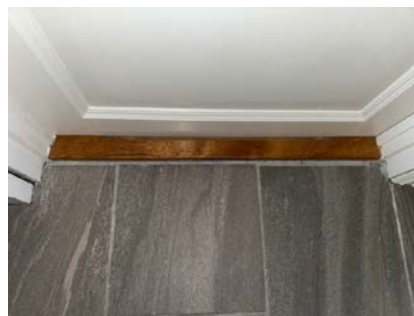
Liten luftespalte under dør.
