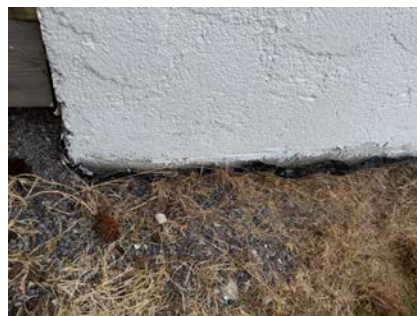
Manglende klemplister i topp på fuktsperre.
