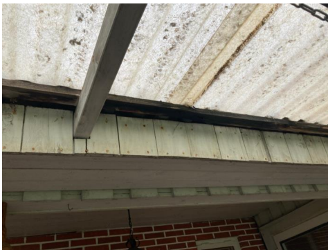
Lekkasje og råteskade i tak over terrasse.
