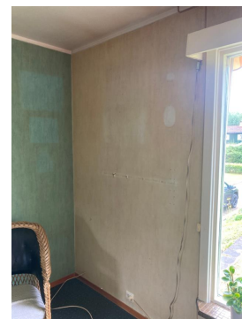
Innvendige overflater må utbedres.
