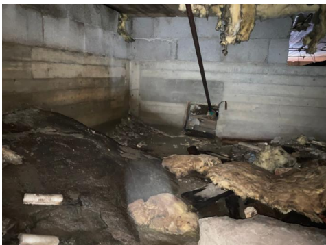
Fukt i krypkjeller.
