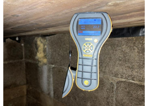
Fuktmåling viste skadelig fukt i krypkjeller.
