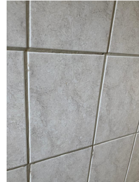
Flislegging er ikke faglig utført.
