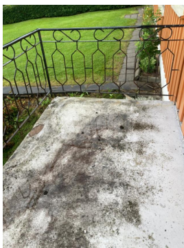
Veranda må utbedres og behandles.
