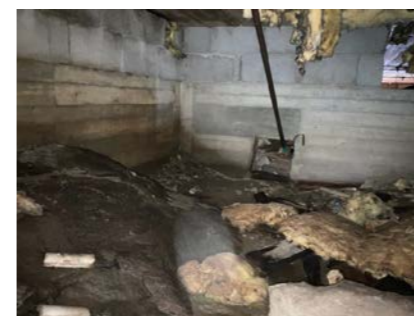
Fukt i krypkjeller.
