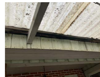
Lekkasje og råteskade i tak over terrasse.
