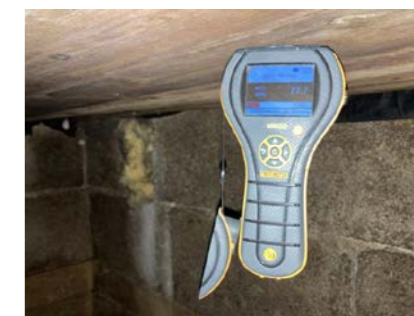
Fuktmåling viste skadelig fukt i krypkjeller.
