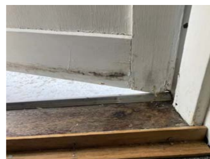
Terrassedør har skader,
