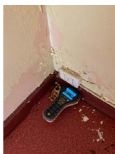
Tegn på fukt i bod, fuktmåling viste normale verdier.
