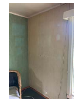
Innvendige overflater må utbedres.
