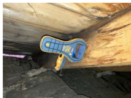
Takspærre med fuktmerker, fuktmåling viste normale verdier.
