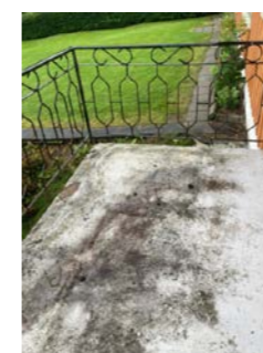
Veranda må utbedres og behandles.
