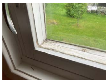
Flere vinduer har slitasje.
