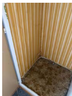
Fuktskjolder i garderobeskap må undersøkes nærmere.
