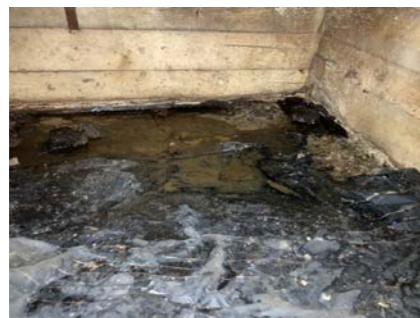
Stående vann i kjeller tyder på svikt i drenering/fuktsikring.
