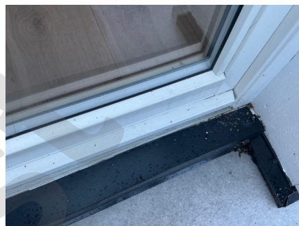
Beslag er ikke riktig montert.
