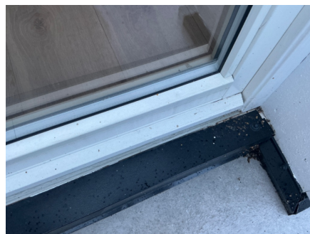
Beslag er ikke riktig montert.
