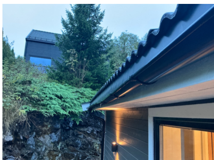
Nedbøying i takrenne.
