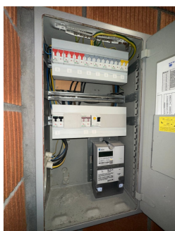
Sikringsskap med automatsikringer.
