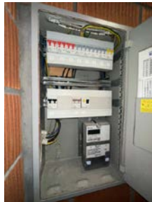
Sikringsskap med automatsikringer.
