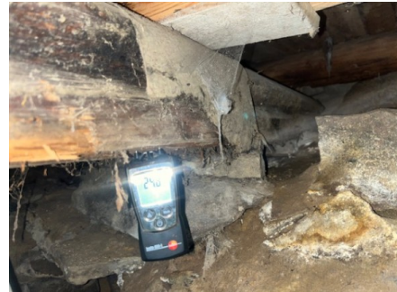
Det er observert råte i en bjelke
