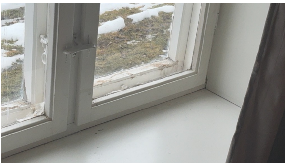
Eksempel på slitasje.
