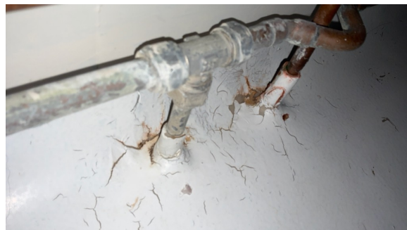
Usikre gjennomføringer i gulv.
