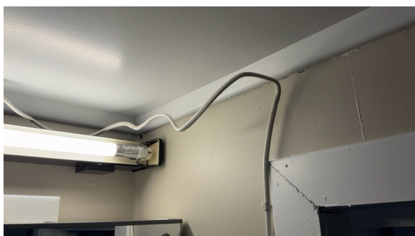
Manglende innfesting av kabel på bad.
