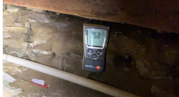
Fuktinnhold i treverk i kryperom på godt over 20 vektprosent.
