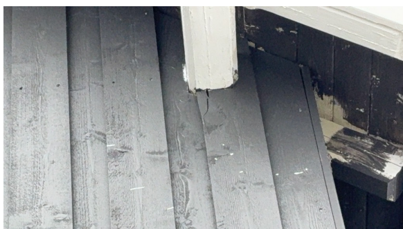
Eksempel på sprekk i kledningsbord.
