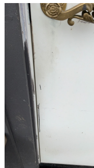
Slitasje og bruksmerker på entredør.
