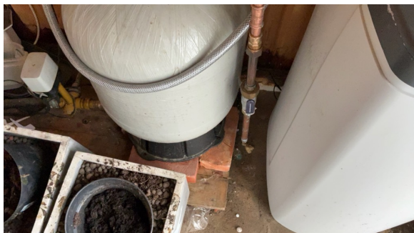
Stoppekran på teknisk rom.
