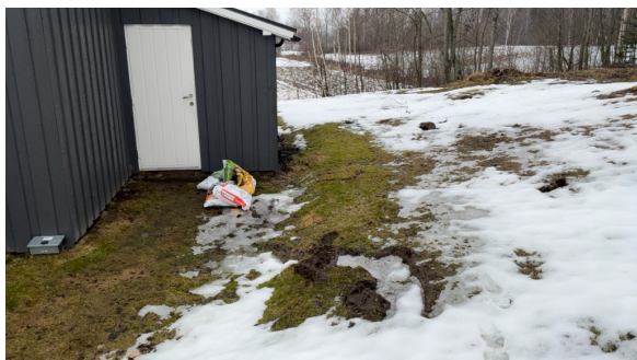
Fall på terreng inn mot bygget.
