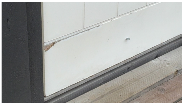
Slitasje på dør ved veranda.
