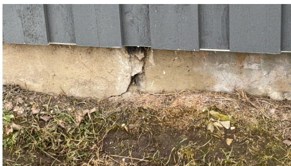
Eksempel på sprekk i grunnmur.
