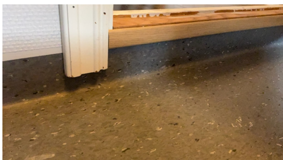
Tett oppkant ved dør.
