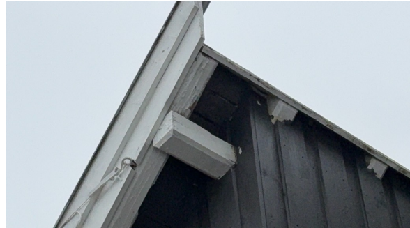
Overflate på treverk indikerer at det kan være råte på takspærre over entre.
