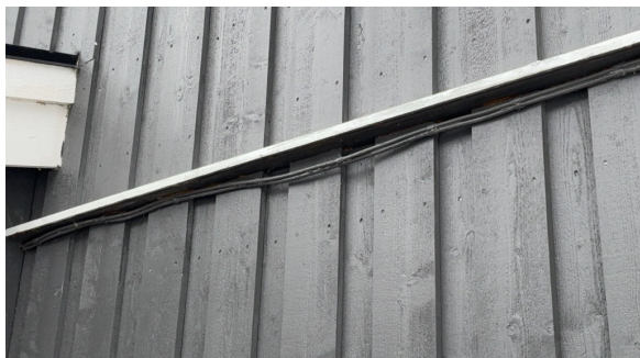
Løs innfesting av kabel.
