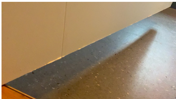
Slitasje på dør til vaskerom.
