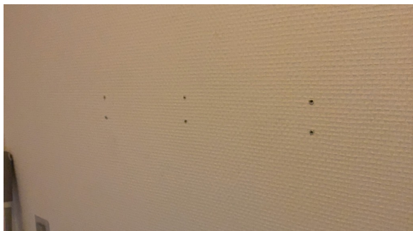
Skruehull i vegger
