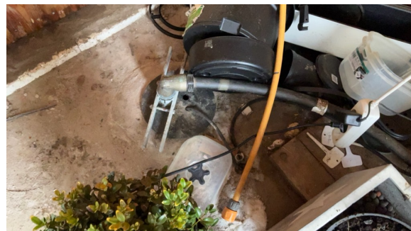
Vanninntak på teknisk rom.
