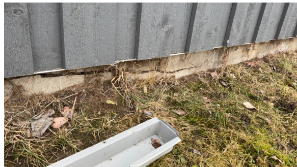
Eksempel på sprekk i grunnmur.
