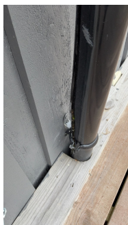
Det er skjevhet og frostspreng på taknedløp ved veranda.
