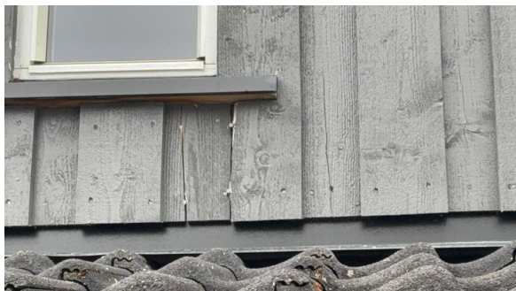
Eksempel på sprekk i kledningsbord.
