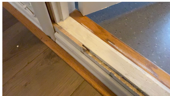
Enkle tilslutninger på dør til vaskerom.
