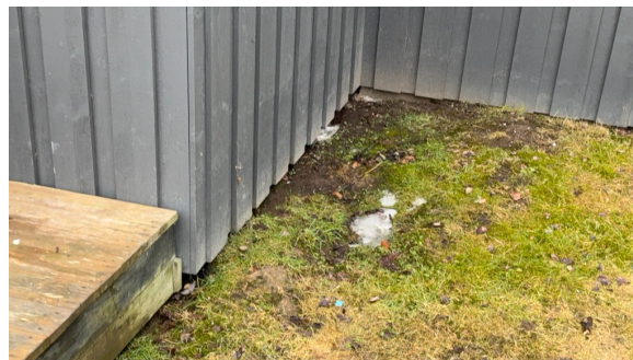
Kledning går nært ned mot terreng.
