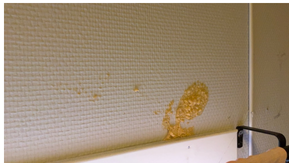
Byggeskum på veggflate
