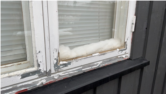
Eksempel på slitasje.
