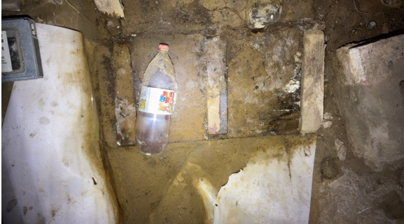
Det ligger vann på bakken i kryperom.
