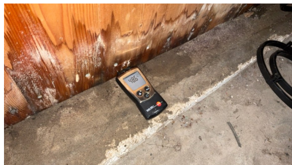
Fuktmerker og høyt fuktinnhold nederst på vegger.
