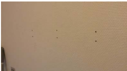
Skruehull i vegger
