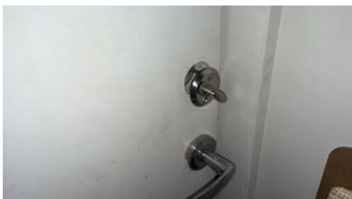
Lås sitter skjevt på verandadør.
