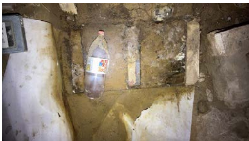
Det ligger vann på bakken i kryperom.
