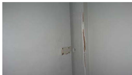
Skade på karm på verandadør.
