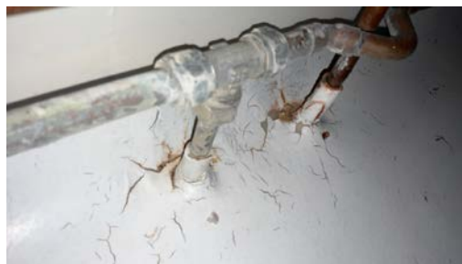
Usikre gjennomføringer i gulv.
