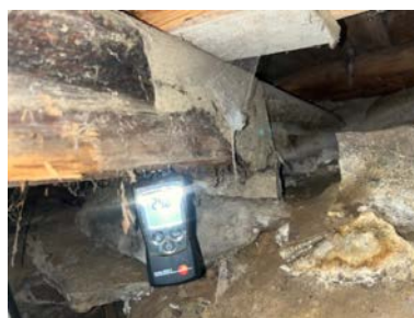
Det er observert råte i en bjelke
