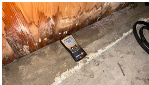
Fuktmerker og høyt fuktinnhold nederst på vegger.
