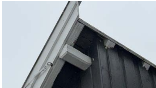
Overflate på treverk indikerer at det kan være råte på taksperre over entre.
