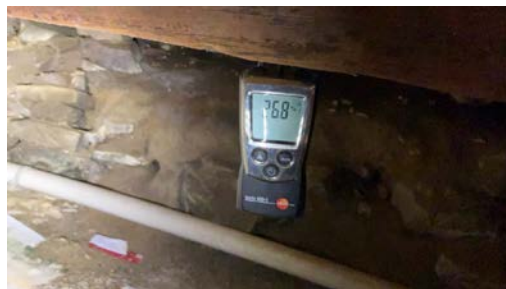
Fukttinnhold i treverk i kryperom på godt over 20 vektprosent.
