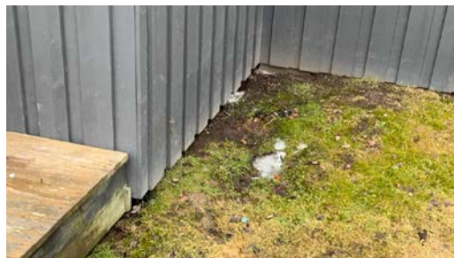
Kledning går nært ned mot terreng.
