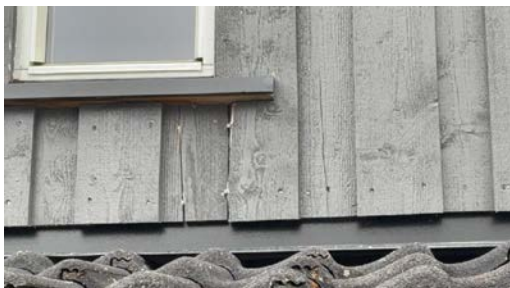
Eksempel på sprekk i kledningsbord.
