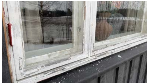
Eksempel på slitasje.
