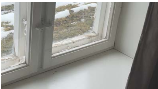
Eksempel på slitasje.
