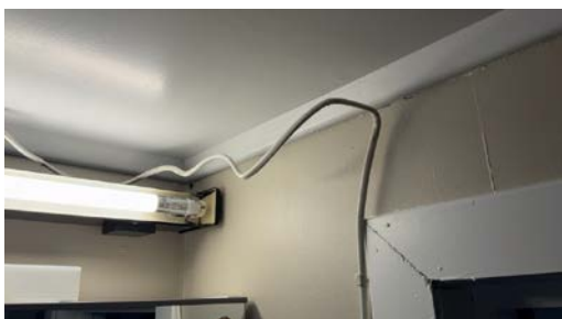
Manglende innfesting av kabel på bad.
