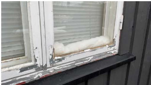
Eksempel på slitasje.
