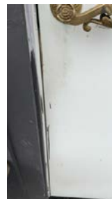
Slitasje og bruksmerker på entredør.
