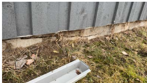
Eksempel på sprekk i grunnmur.
