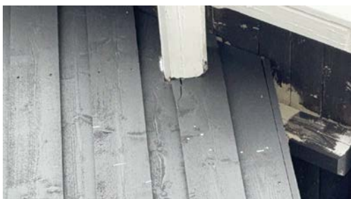
Eksempel på sprekk i kledningsbord.
