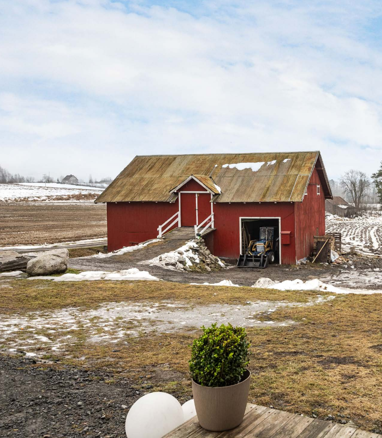
Låven er punktfundamentert og bygget med reisverk, og har behov for vedlikehold.
