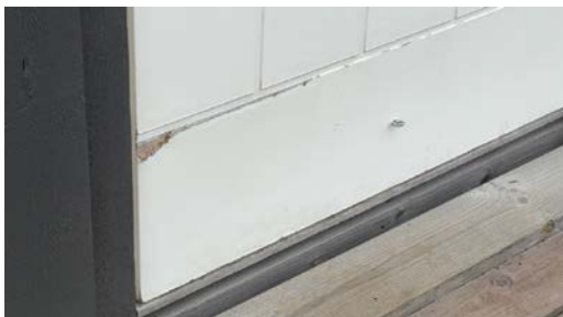
Slitasje på dør ved veranda.
