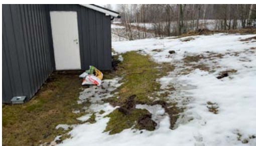
Fall på terreng inn mot bygget.
