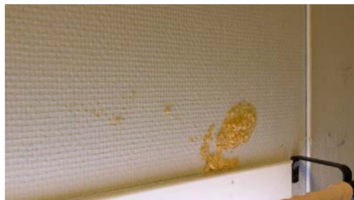
Byggeskum på veggflate
