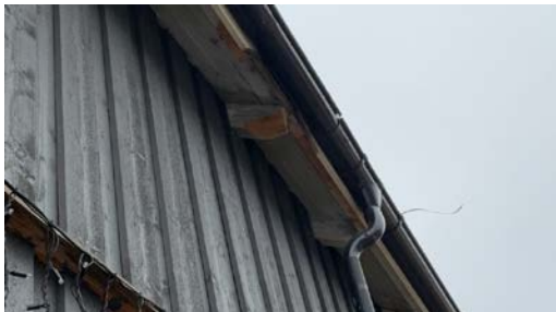
Eksempel på gjenværende malingsarbeid.
