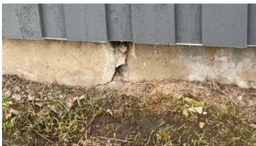
Eksempel på sprekk i grunnmur.
