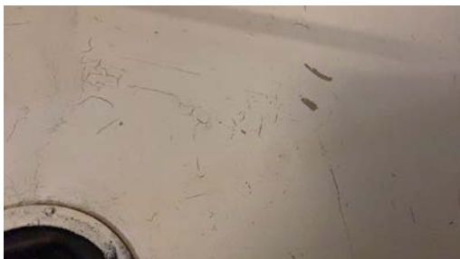
Eksempel på slitasje.
