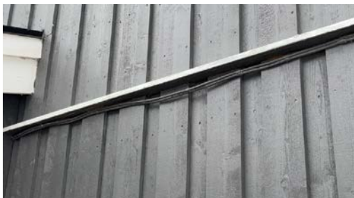
Løs innfesting av kabel.
