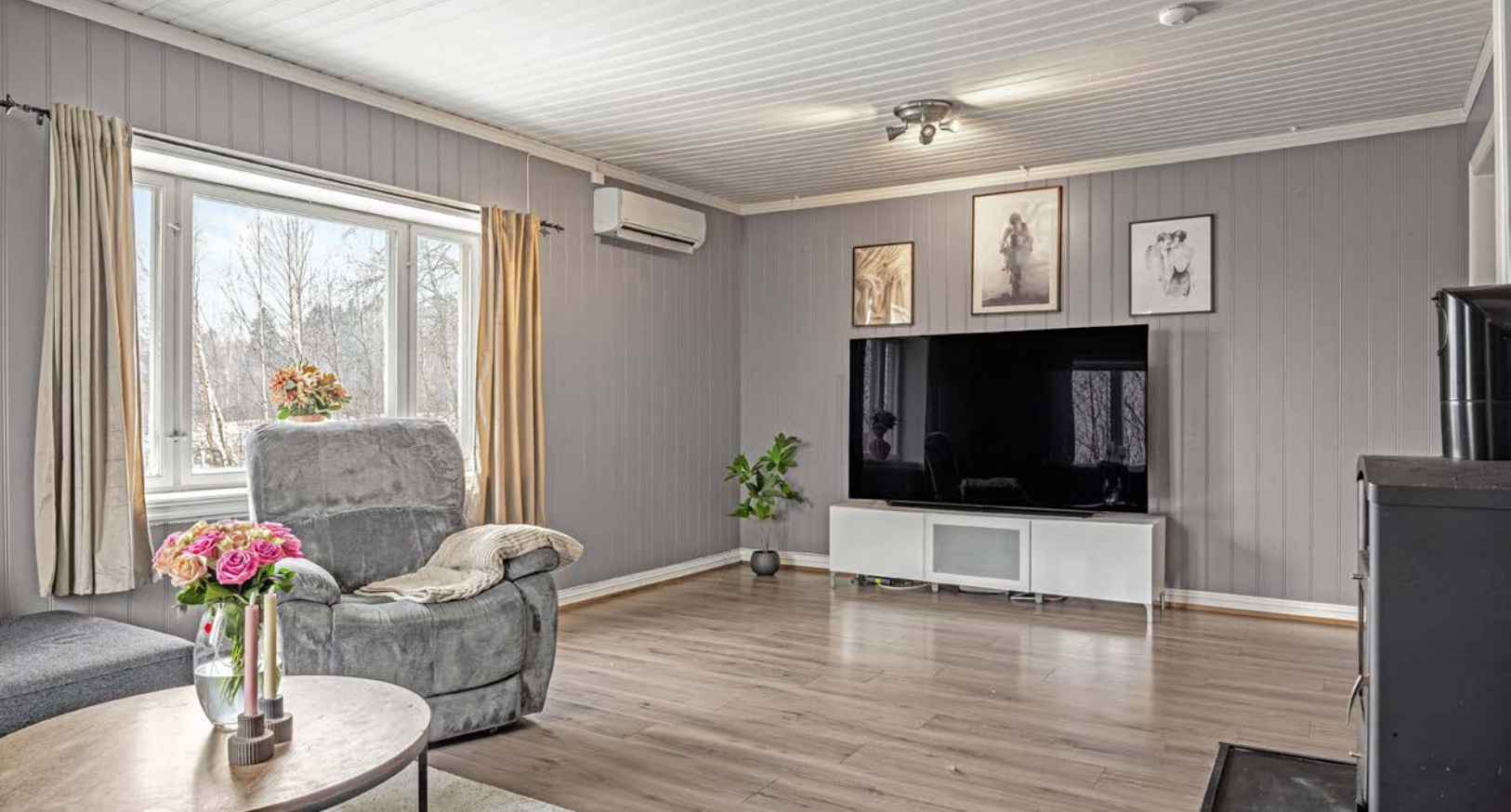
I stuen er det installert varmepumpe, denne er fra 2010.
