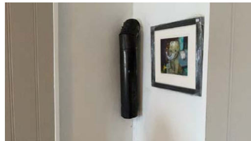
Åpent røykrør i 2. etasje.
