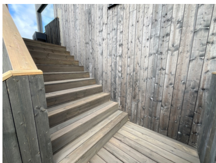
Mangler håndløper i trappeløpet.
