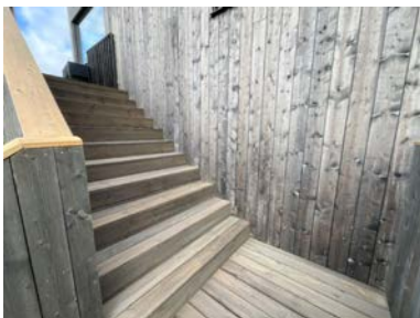
Mangler håndløper i trappeløpet.
