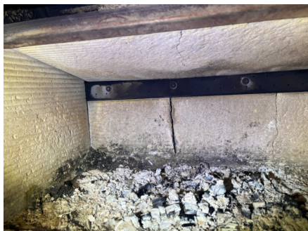
Sprekk i ildfast stein i ovn på 1 etasje
