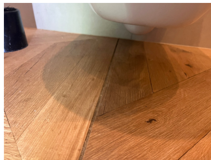
Ikke dreneråpning under toalett
