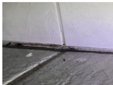
Sprekk i elastisk fuge
