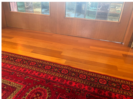
Dørblad tar i gulvet på grunn av en kul i gulvet.
