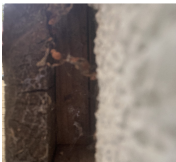
Ikke tilfredsstillende lufting bak kledningen
