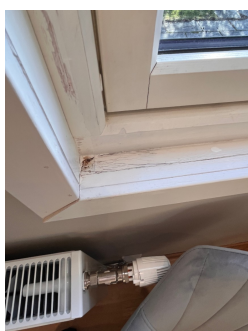
Merker etter fukt på vindu i kjøkken
