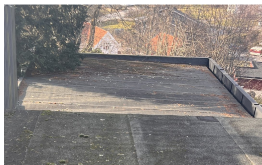
Tak på tilbygg noe mosegrodd.
