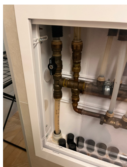
Fordelerskap til bad og vaskerom i underetasjen
