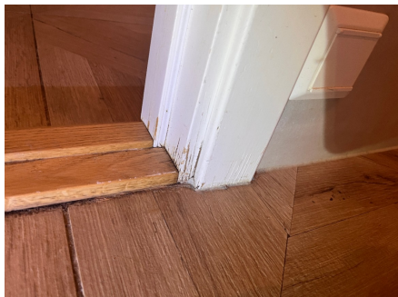
Anslagsterskel, karm er påvirket av fukt.
