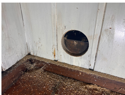
Fukt i vegg mot dusjsone.
