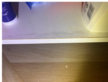
Fuktsvelling på skapskrog
