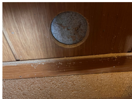
Fuktkontroll under trapp i underetasjen, måling viser 9,3 vektprosent på bakside av veggplate, defineres som tørt.
