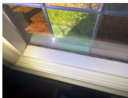
Merker etter kondensvann
