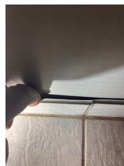
Sokkelfliser på utside av veggplater i dusjsone.
