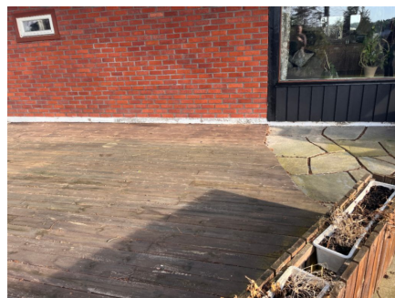
Skallmur uten dreneringsåpninger.
