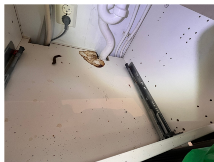
Merker etter fukt i bunn på skapskrog under benkebeslaget.
