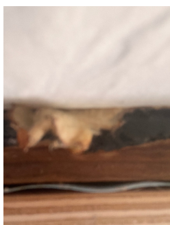
Overgang gulv/ vegg er ikke dampnett.
