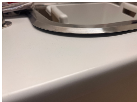
Benkebeslaget er ikke skikkelig fastmontert
