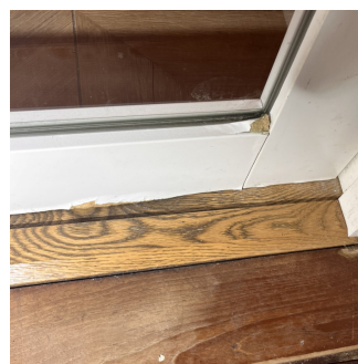
Fuktskade på dør til tilbygg.
