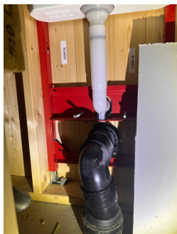
Hulrom bak det vegg monterte toalettet
