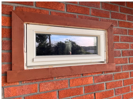
Det er ikke montert beslag over og under vindu
