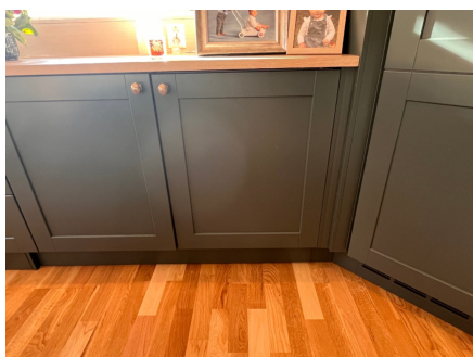
Ikke montert lufte rist under frysenskapet
