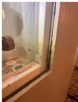
Ramme på fordelerskap ikke montert
