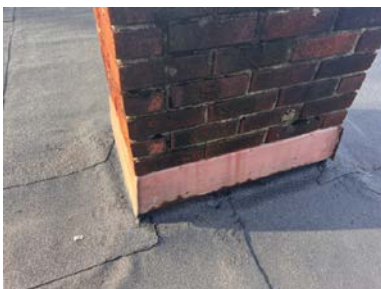
Rust på sokkelbeslag på pipe.
