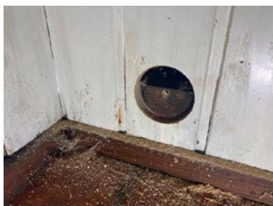
Fukt i vegg mot dusjsone.
