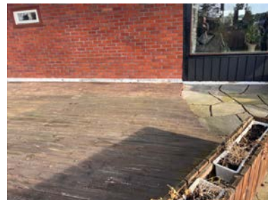
Skallmur uten dreneringsåpninger.
