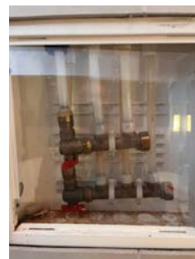
Fordelerskap til bad i 1 etasjen
