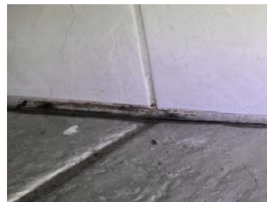
Sprekk i elastisk fuge
