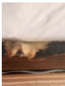
Overgang gulv/ vegg er ikke dampstett.
