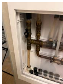
Fordelerskap til bad og vaskerom i underetasjen
