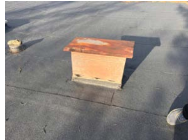
Luftelhatt fra byggeåret, noe rustet
