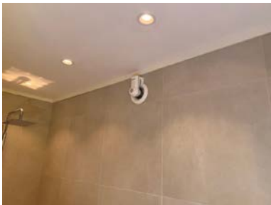
Vifte i vegg på bad, trekker også fra vaskerommet.
