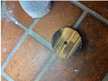
Mugg på bakside av panel i hull på vegg mot grunnmur.
