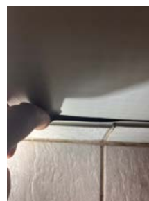
Sokkelfliser på utside av veggplater i dusjsone.
