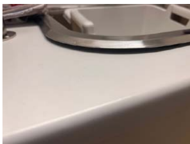
Benkebeslaget er ikke skikkelig fastmontert
