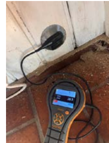
Fuktkontroll i vegg mot grunnmur på garderobe/bad i tilbygg, isopor på vegg bak panel.
