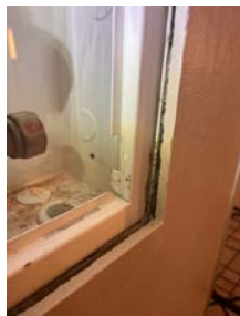
Ramme på fordelerskap ikke montert
