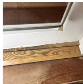
Fuktskade på dør til tilbygg.
