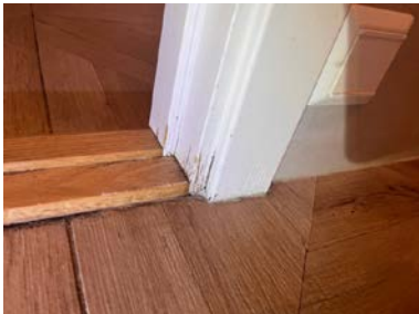
Anslagsterskel, karm er påvirket av fukt.
