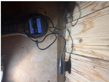
Synlige merker etter fukt på panel i badstue og fuktnivå som tilsier at det kan være skader bak panel.
