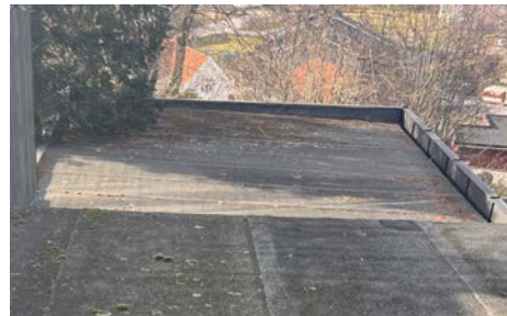
Tak på tilbygg noe mosegrodd.
