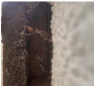
Ikke tilfredsstillende lufting bak kledningen
