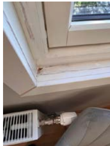
Merket etter fukt på vindu i kjøkken
