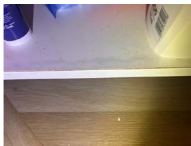
Fuktsvelling på skapskrog
