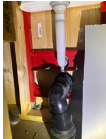
Hulrom bak det vegg monterte toalettet
