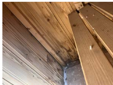
Merker etter fukt i bunn på vegger
