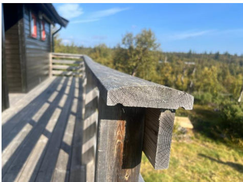
Skjevhet i rekkverk
