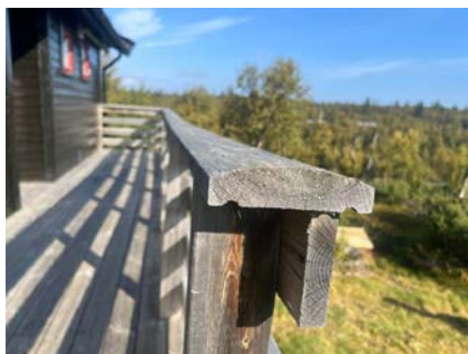
Skjevhet i rekkverk
