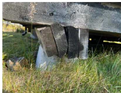
Vridning i bærebjelker, jmf eier foretatt lokale tiltak og nærmere undersøkelse anbefales
