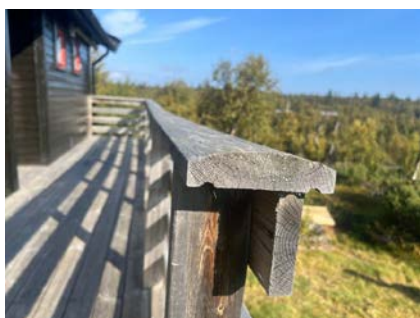
Skjevhet i rekkverk
