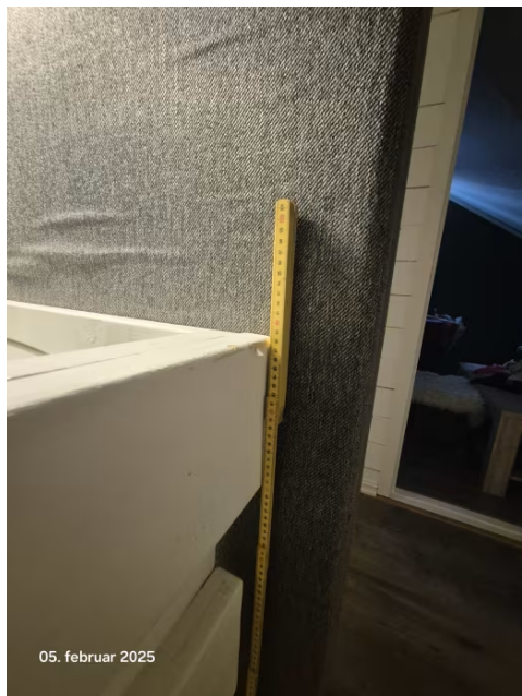
Rekkverk er akkurat litt for lavt i 2.etg.
