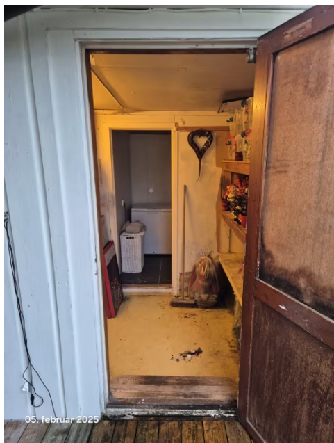
Råteskader på dør til bod/vaskerom.
