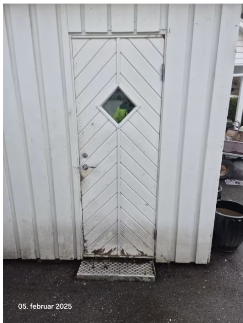
Råteskader på dør til garasje.
