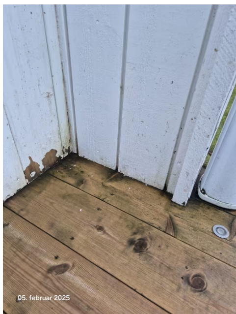
Avskallinger og råteskader.
