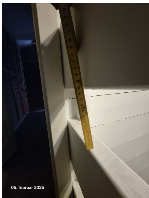
Åpninger mellom rekkverk i 2. etg.
