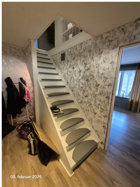
Håndløper og rekkverk mangler.
