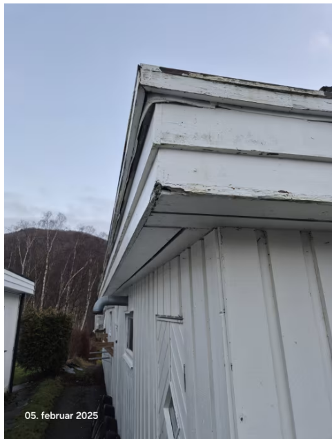
Råteskader på vindski
