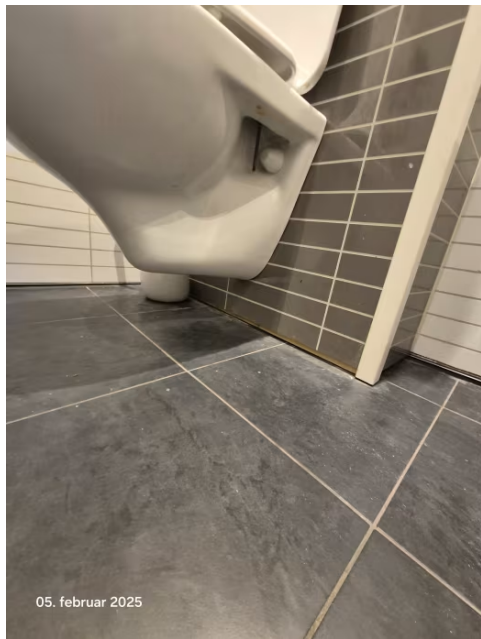
Drensspalte mangler under WC. Eksponert treverk på gulvet.
