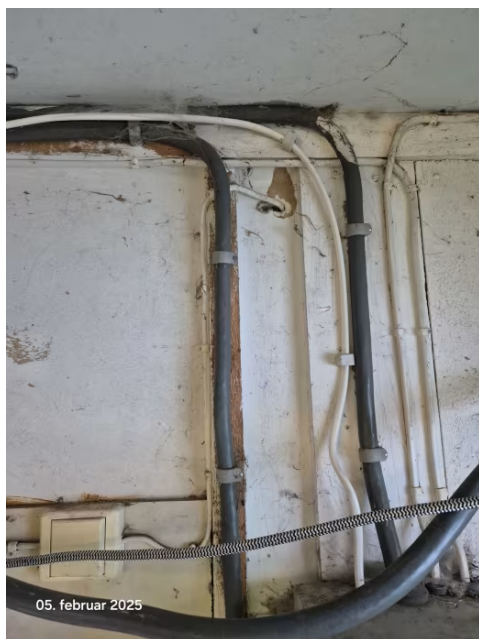
Kabler som bør festes bedre.
