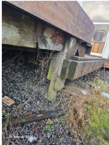
Bildet viser søyler som er ført rett i grunn. Dette gjør at treverk er spesielt utsatt for fukt-og råteskader, samt setning.
