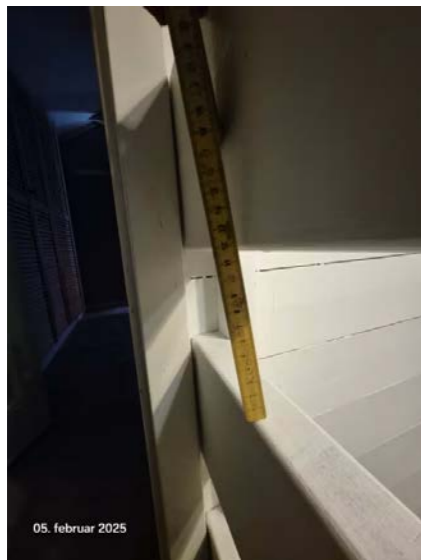
Åpninger mellom rekkverk i 2. etg.
