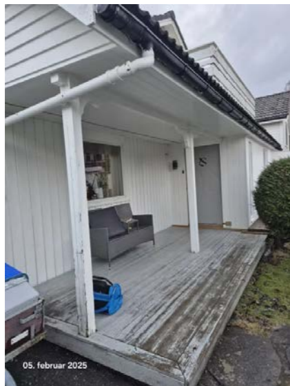
Værslitt platting ved inngang. Grønne og svartesopp bør vaskes bort.
