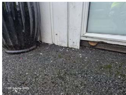
Ingen lufting av kledningsbord ved garasje.
