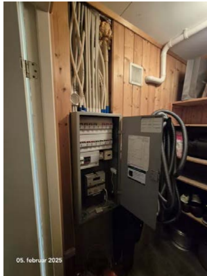
Uferdige arbeider rundt sikringsskap.
