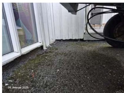
Avskallinger og råteskader i bunn av kledning.
