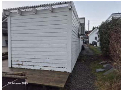
Avskallinger og påbegynnende råteskader på kledning.
