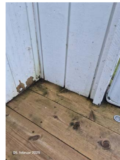
Avskallinger og råteskader.
