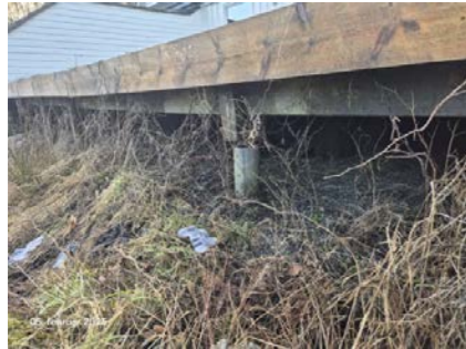
Søyler som står på pilarer er stedvis skjeve, tyder på at de kan ha sklidd ut.
