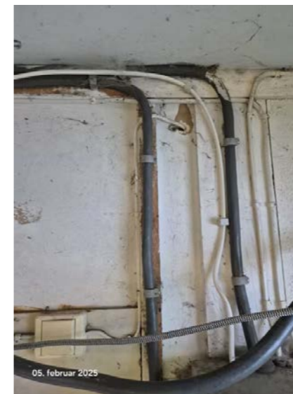
Kabler som bør festes bedre.
