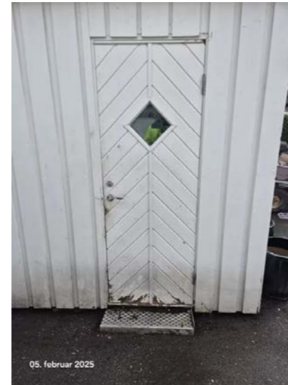
Råteskader på dør til garasje.
