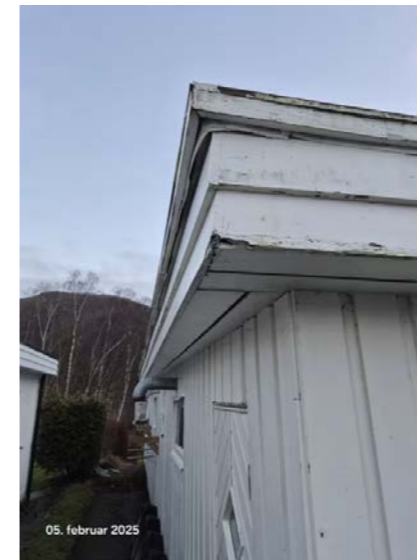
Råteskader på vindski
