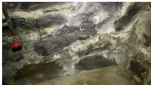
Saltutslag på grunnmur.
