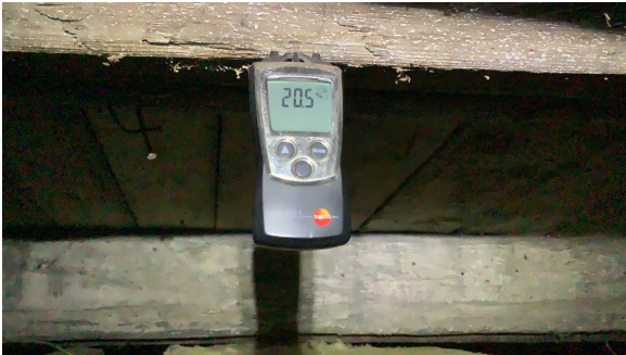
Skadelig fuktinnhold i gulvbjelke i kjeller ved krypkjeller.
