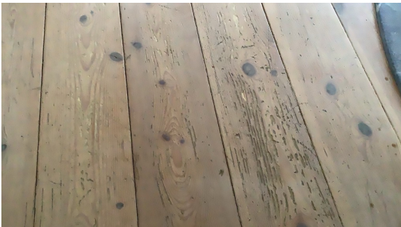
Slitasje i heltregulv.
