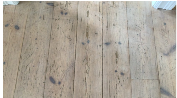
Slitasje i heltregulv.
