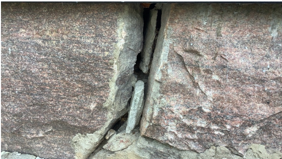
Sprukket mørtel mellom gråsteiner.
