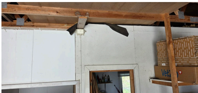
Bilde 1 Kabel i garasje er dekket av plater på 2 sider på bakvegg.
