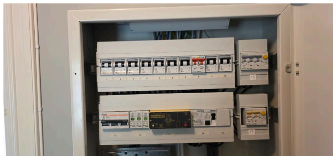
Bilde 2 Anbefalt og bygge om til jordfeilautomater.
