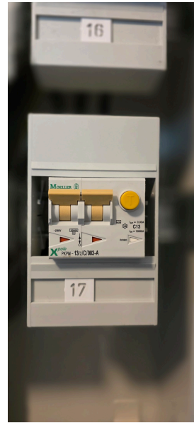
Bilde 2 Løser ut noe tidlig. 6mA bør ligge over 22mA. Mangler avdekning på sidene.
