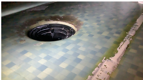
Plastsluk, og vinylbelegg er synlig ført under slukets klemring.
