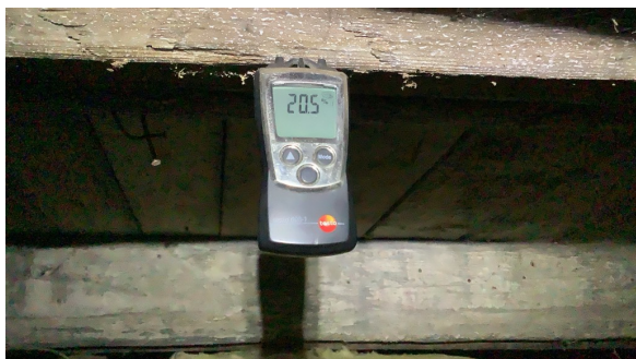
Skadelig fuktinnhold i gulvbjelke.
