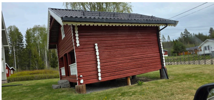
Bilde 1 Stabbur er frakoblet strøm, men det finnes opplegg som ikke er inspisert.
