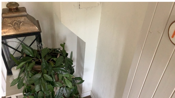
Ildfast plate mangler på gulv under sotluke.
