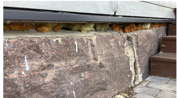
Glippe mellom grunnmur og vegg.
