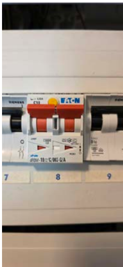
Bilde 1 Kurs 8 løser ikke ut på testknapp. Ligger også med jordfeilbryter foran som løser ut.
