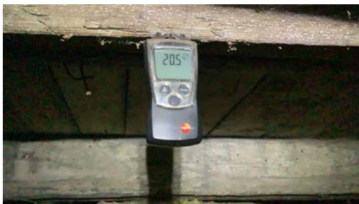
Skadelig fuktinnhold i gulvbjelke.
