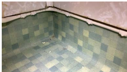
Hjørner er ikke sveiset, og disse er derfor ikke tette.
