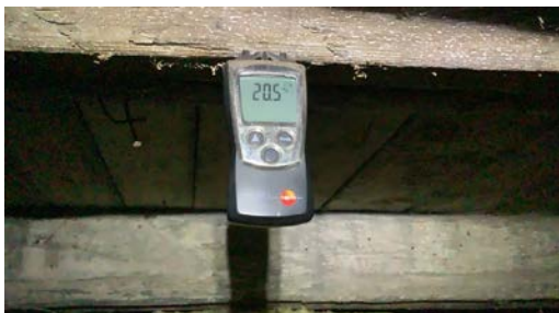
Skadelig fuktinnhold i gulvbjelke i kjeller ved krypkjeller.
