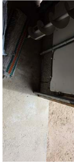
Bilde 2 Kabel ligger uten beskyttelse lavere en 150cm.
