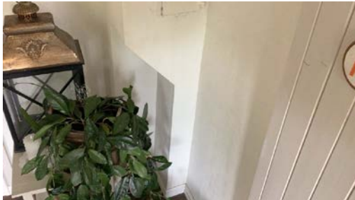
Ildfast plate mangler på gulv under sotluke.
