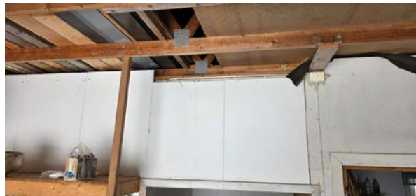
Bilde 2 Man ser kabel på deler og så går det bak plater på venstre side.
