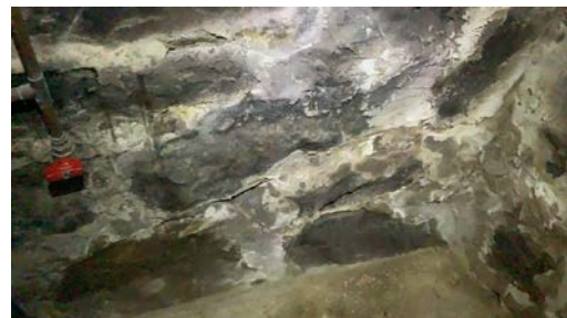
Saltutslag på grunnmur.
