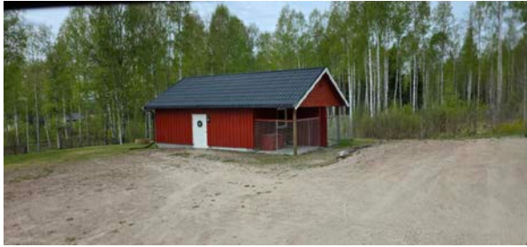
Bilde 1 Mangler jordelektrode og bygg dekkes ikke av elektrode bolig. Bør slås ned jordspyd lokalt.
