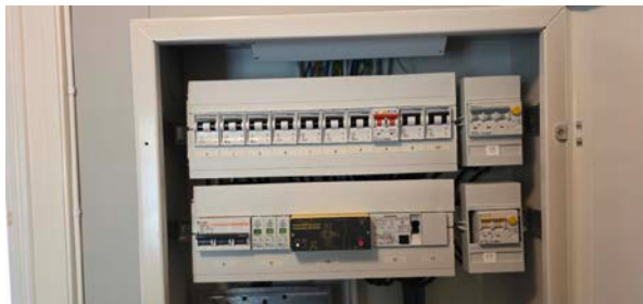
Bilde 2 Anbefalt og bygge om til jordfeilautomater.
