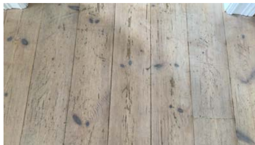
Slitasje i heltregulv.
