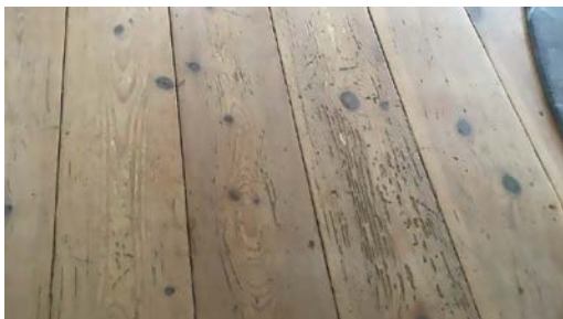
Slitasje i heltregulv.
