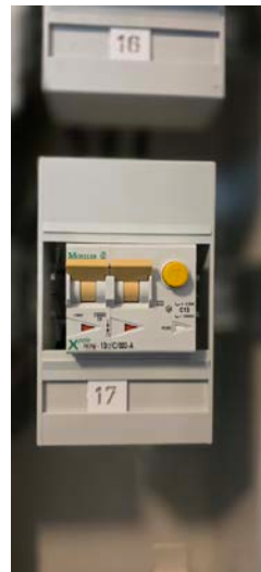
Bilde 2 Løser ut noe tidlig. 6mA bør ligge over 22mA. Mangler avdekning på sidene.
