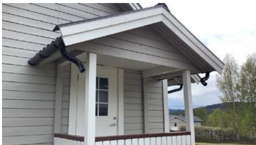
Det er ikke montert nedløpsrør.
