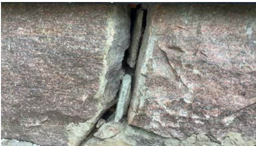
Sprukket mørtel mellom gråsteiner.
