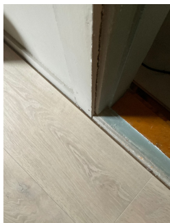
Glipper mellom laminat og gulvlist
