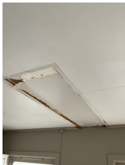
Oppgraderingsbehov i kjøkkentak.
