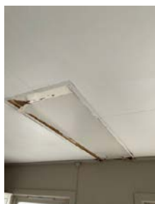
Oppgraderingsbehov i kjøkkentak.
