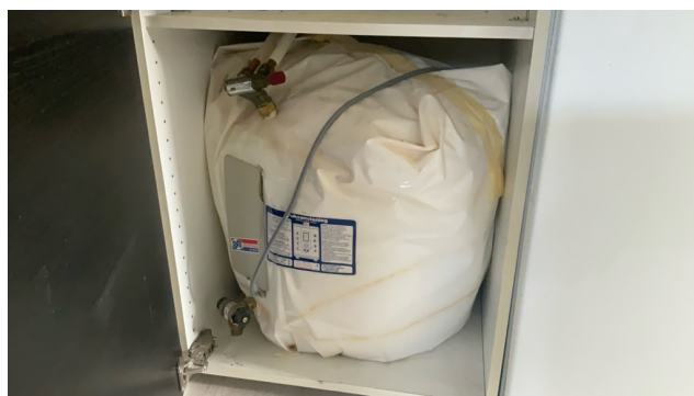
Varmtvannstank i kjøkkenskap i del mot syd.
