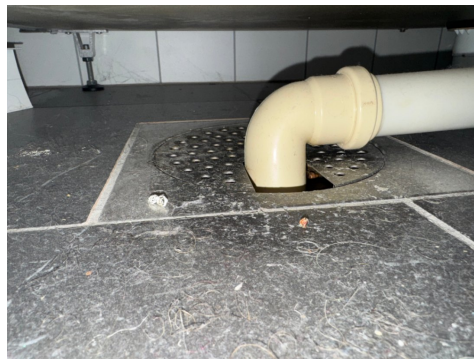
Sluk under dusjkabinett
