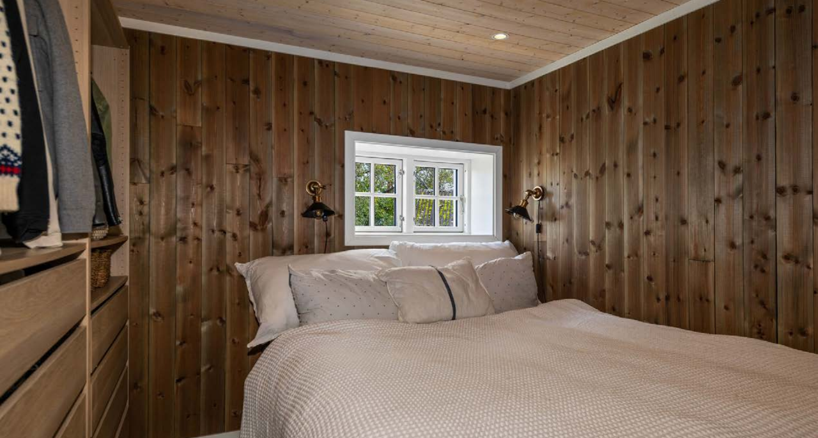
Rommet har ikke tilstrekkelig rømning via vindu.
