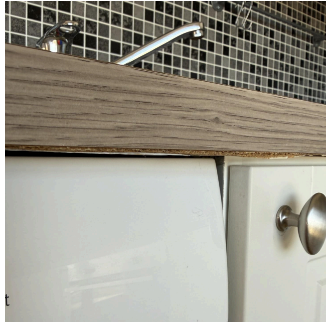
Svelling i benkeplate
