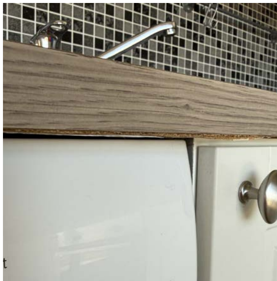
Svelling i benkeplate
