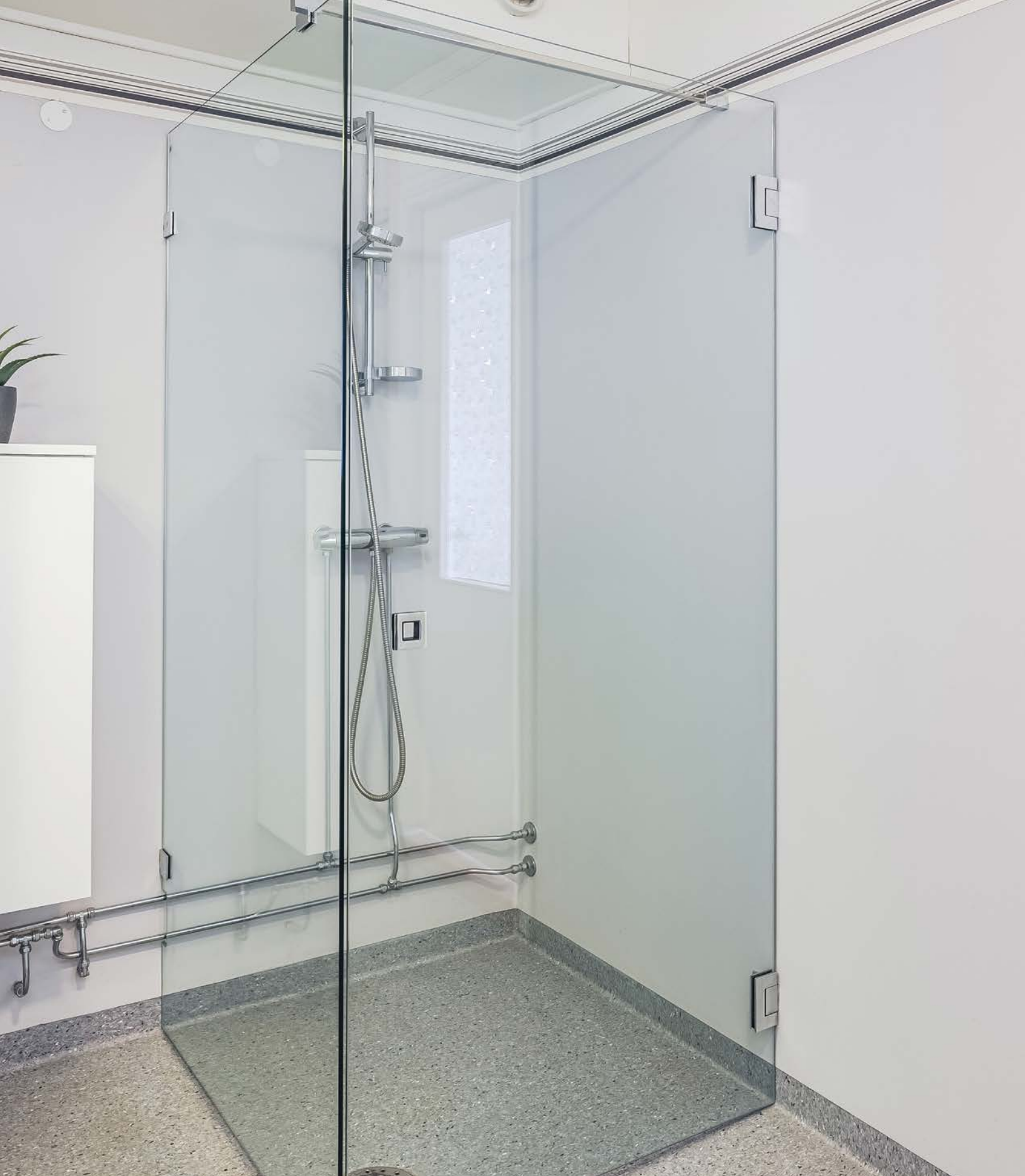
Dusjhjørne med vegghengt dusjbatteri.
