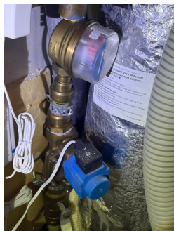
Sjakt på baderommet med stoppekran/ vannmåler
