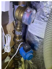
Sjakt på baderommet med stoppekran/ vannmåler
