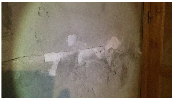
Eksempel på innvendig sprekk i grunnmur.
