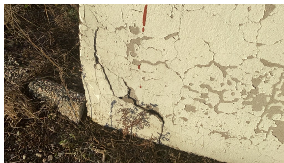
Eksempel på utvendig sprekk i grunnmur.
