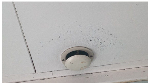
Det er swelling i himling ved ventil.
