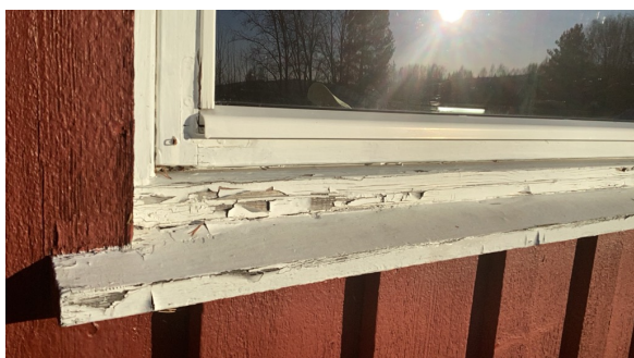
Eksempel på utvendig slitasje.
