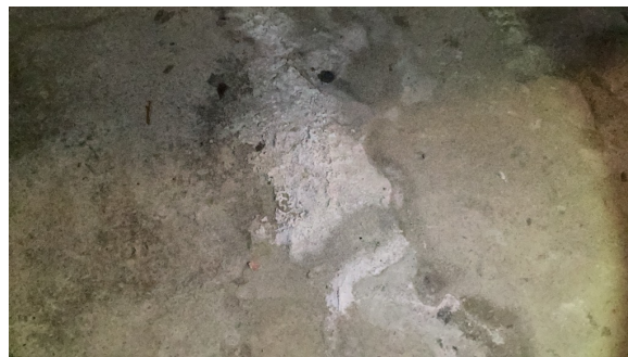
Eksempel på saltutslag på gulv.
