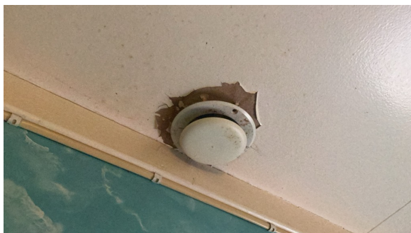
Avskaling av maling rundt ventil i himling.
