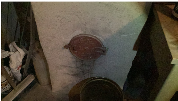
Sotluke i kjeller.
