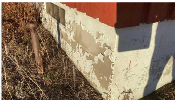
Eksempel på avskaling på grunnmur.
