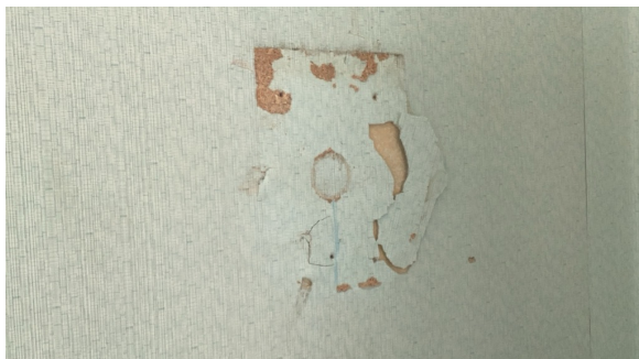
Eksempel på skade på vegg.
