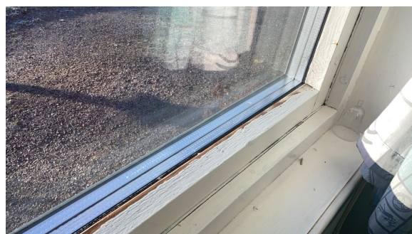
Eksempel på innvendig slitasje.
