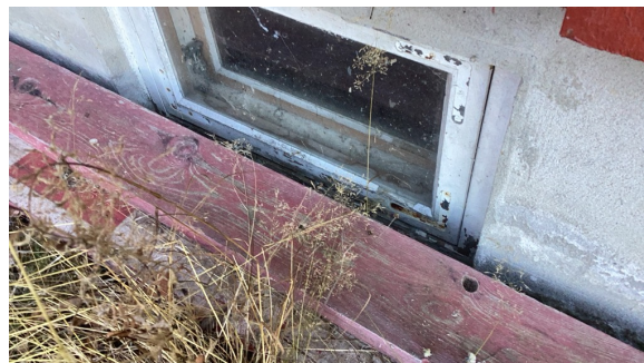
Flere kjellervinduer har råteskader.
