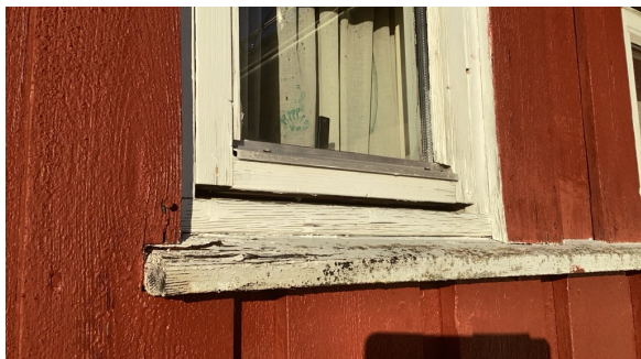
Eksempel på slitasje på vannbrett.
