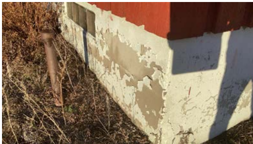
Eksempel på avskaling på grunnmur.
