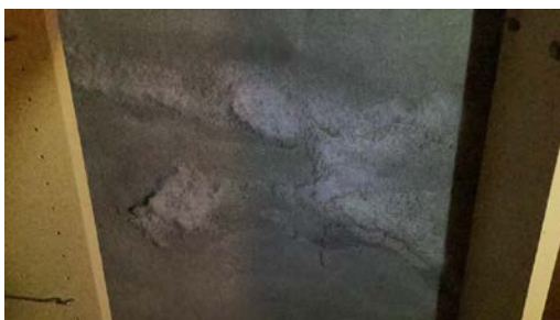
Eksempel på saltutslag på vegg.
