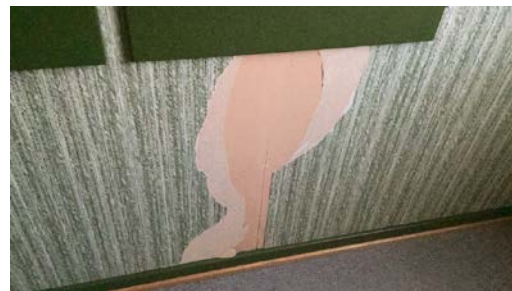
Eksempel på slitasje på tapet.
