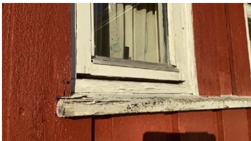
Eksempel på slitasje på vannbrett.
