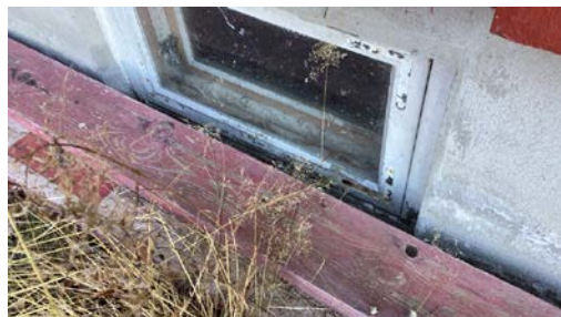
Flere kjellervinduer har råteskader.
