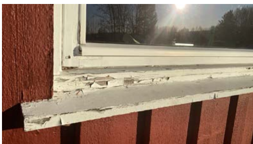
Eksempel på utvendig slitasje.
