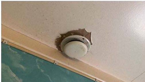
Avskaling av maling rundt ventil i himling.
