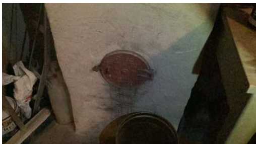
Sotluke i kjeller.
