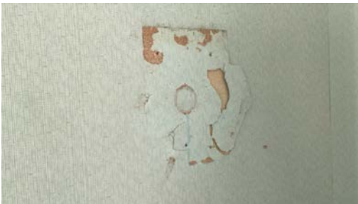
Eksempel på skade på vegg.
