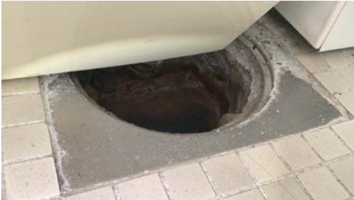
Det er ikke tegn til bruk av membran i sluk.
