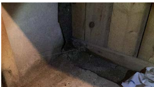
Noen steder skader på trevegger.
