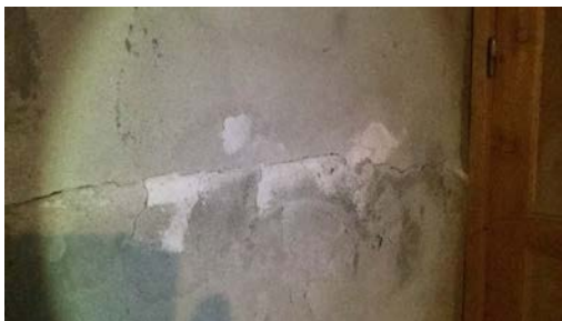
Eksempel på innvendig sprekk i grunnmur.
