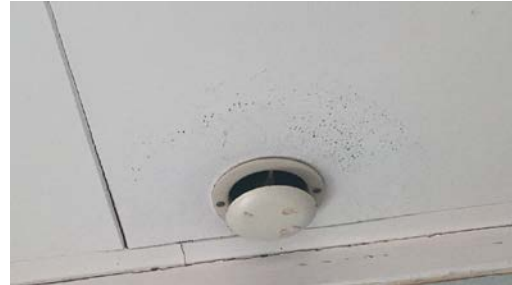
Det er svelling i himling ved ventil.
