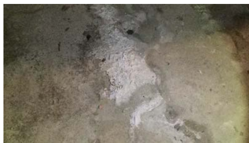
Eksempel på saltutslag på gulv.
