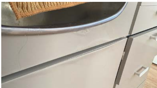
Svelleskade ved vask.
