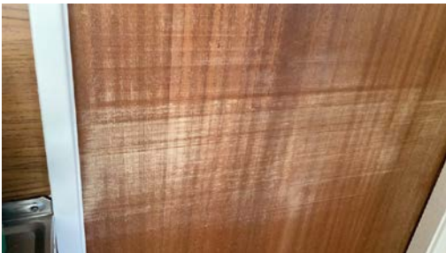
Eksempel på slitasje på dør i 1. etasje.
