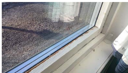
Eksempel på innvendig slitasje.
