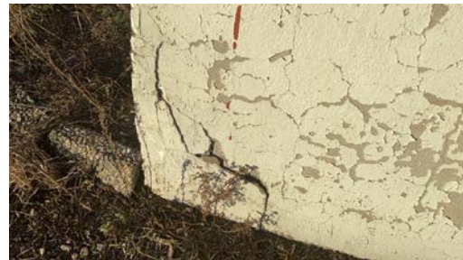
Eksempel på utvendig sprekk i grunnmur.
