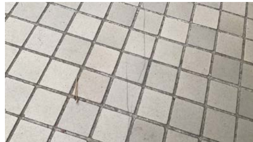
Eksempel på sprekk i fliser.
