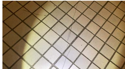
Eksempel på sprekk i fliser på gulv.
