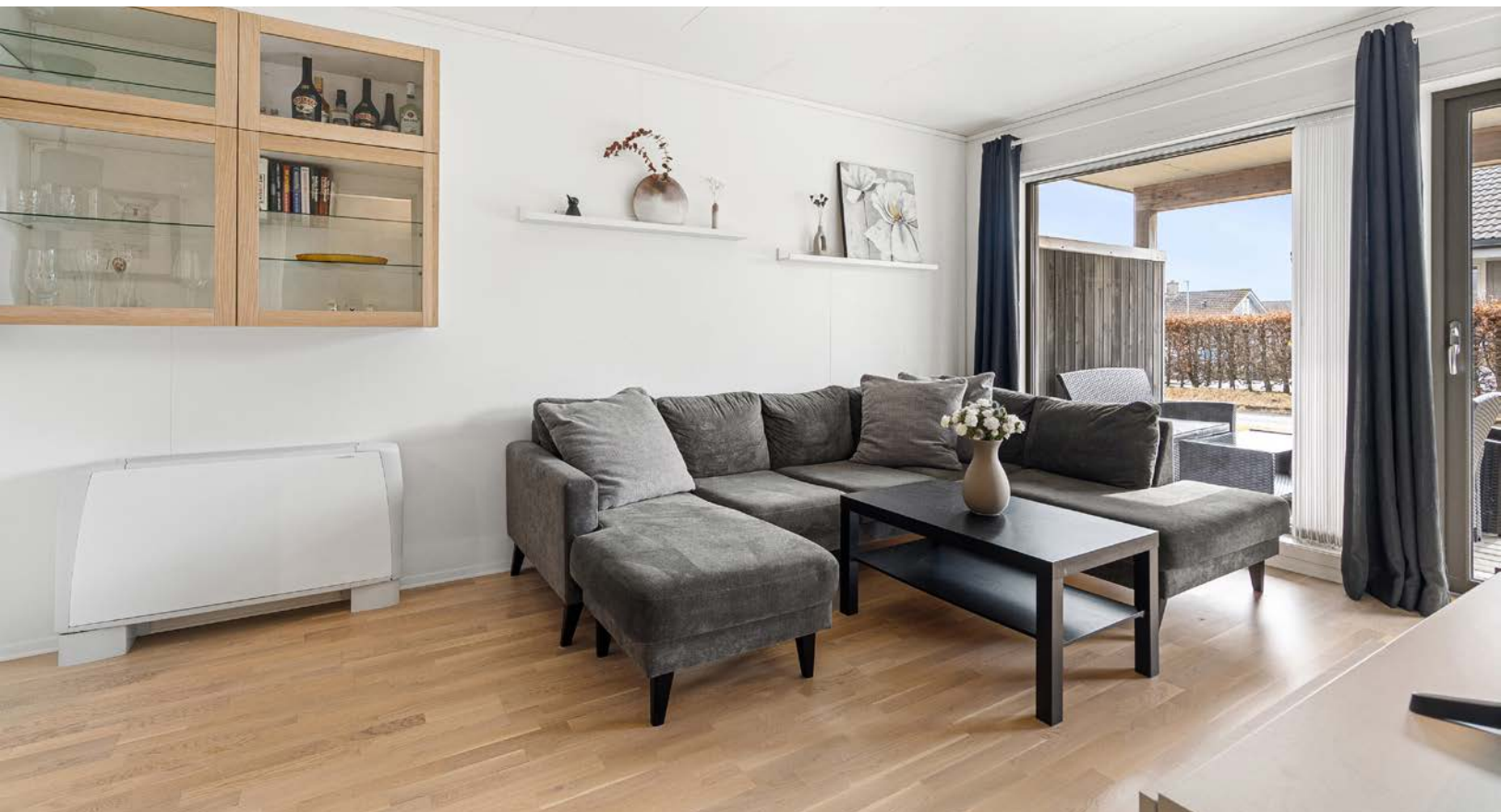
En diskret plassert viftekonvektor sørger for oppvarming på vinteren
