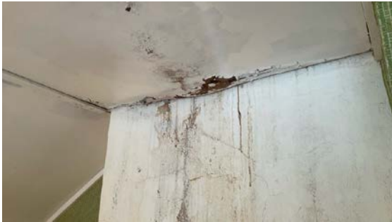
Ved pipe soverom syd.
