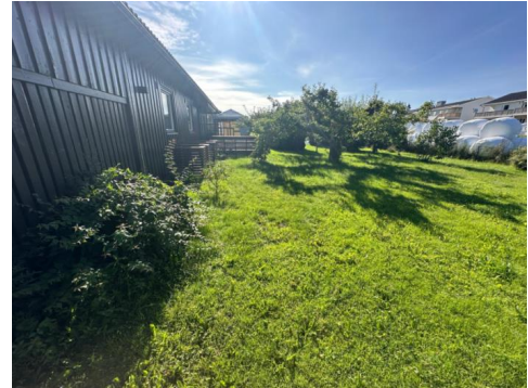
Svakt fall på terreng mot grunnmur.
