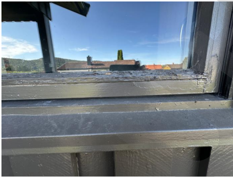
Slitasje i vinduer.
