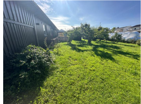
Svakt fall på terreng mot grunnmur.
