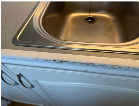
Slitasje i front på benkeplate.
