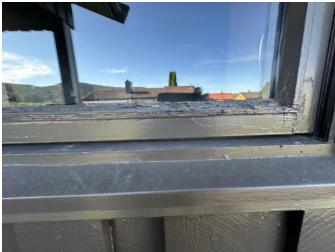
Slitasje i vinduer.
