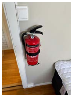
Brannslukningsapparat på soverom.
