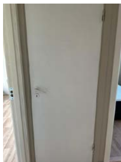
Slitasje i låskasse på dør til kjeller.
