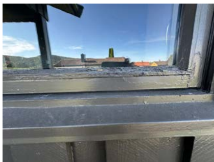
Slitasje i vinduer.
