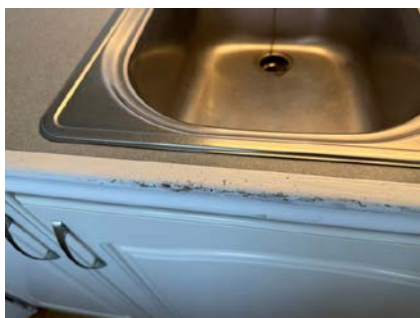
Slitasje i front på benkeplate.
