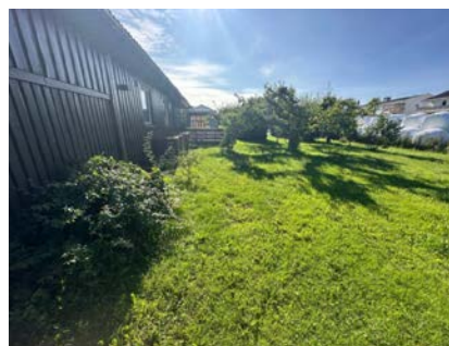
Svakt fall på terreng mot grunnmur.
