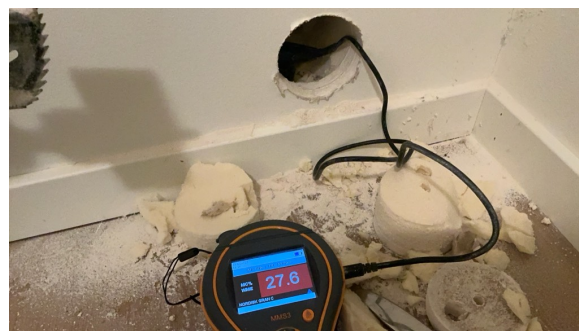
Måling av trefukt i utlektet veggkonstruksjon fra bod i kjeller.
