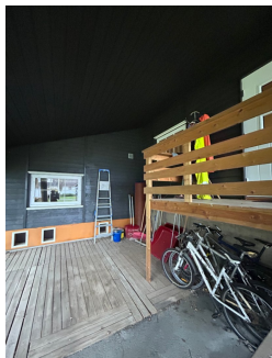
Rekkverk med mangler i forhold til dagens krav.
