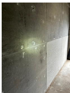
Plater av ukjent materiale. Asbest kan ikke utelukkes.
