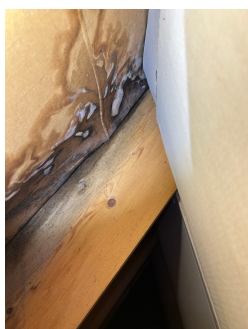
Fuktskader ved overgang knevegg og tak. Skjulte skader kan ikke utelukkes. Bilder fra befaring 13.11.2025.
