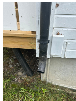
Mangelfull bortledning av vann fra grunnmuren.
