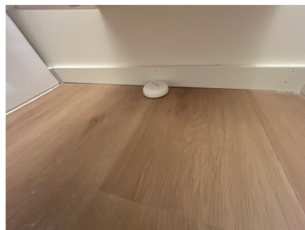
Lekkasjevarsler er montert.
