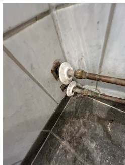
Kobberrør vurdert til å være fra byggeår.
