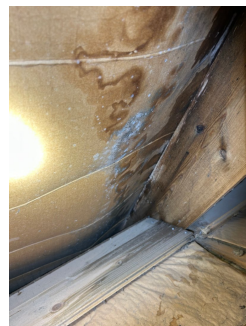
Fuktskader på undertak og takstol. Bilder fra befaring 13.11.2025.
