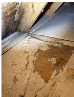
Synlig vann på isolasjon i blindkott. Bilder fra befaring 13.11.2025.
