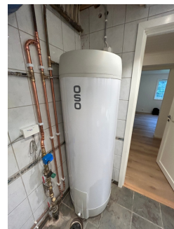
Fordelerstamme for rør-i-rør med tilhørende vannrør vurdert til å være fra byggeår.
