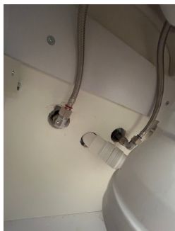
Rør-i-rør avsluttet på innside av vegg.
