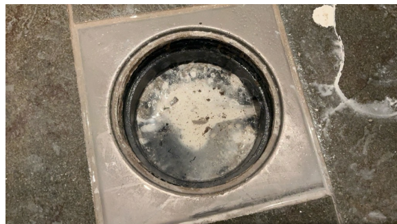
Sluk i dusjsone.
