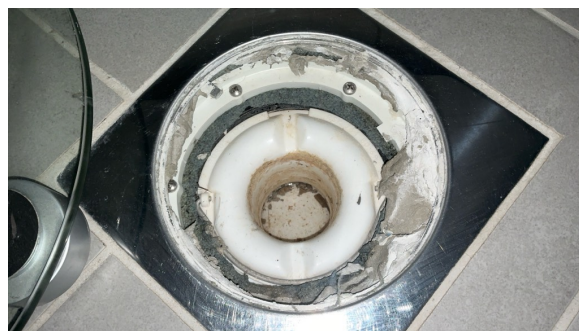
Sluk under servantskap.
