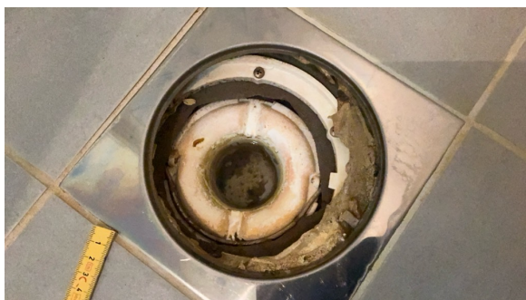
Sluk i dusjsone.
